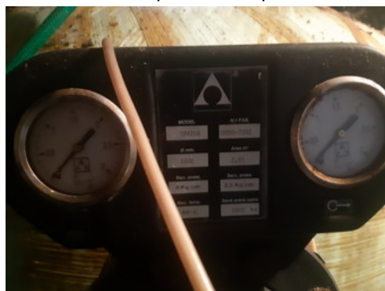
Foto 28: Depuración de piscinas
