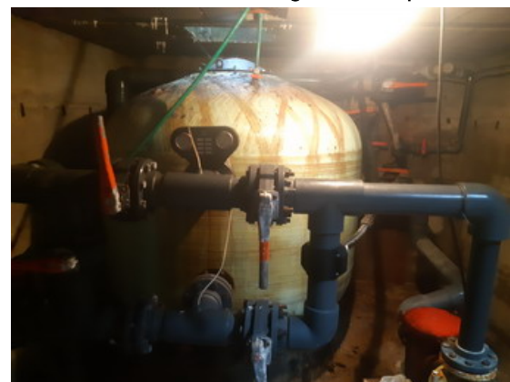
Foto 24: Depuración de piscinas
