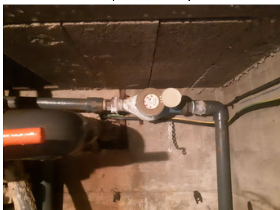
Foto 27: Depuración de piscinas
