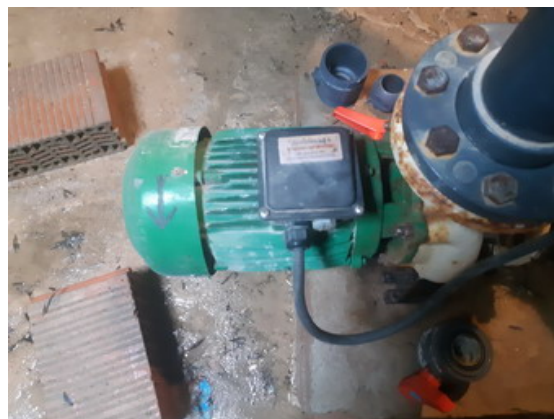
Foto 26: Depuración de piscinas
