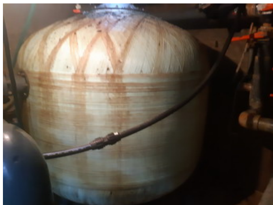
Foto 25: Depuración de piscinas
