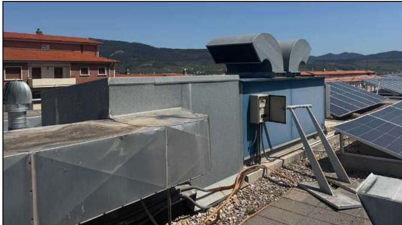
Imagen. Unidad climatizadora nº2 a sustituir
