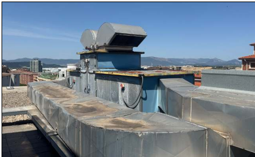
Imagen. Unidad climatizadora nº1 a sustituir
