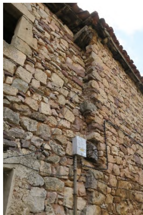
Junta del muro hacia el patio del ala este.
