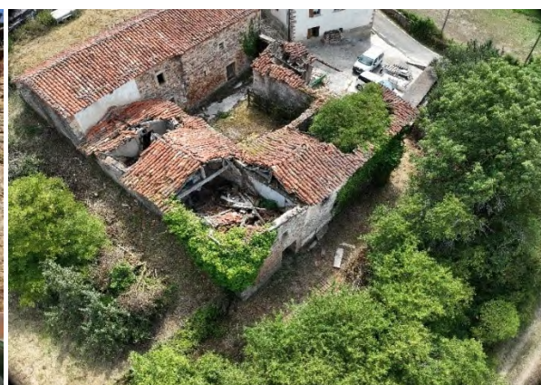
Cubiertas arruinadas de las alas norte, oeste y sur.
