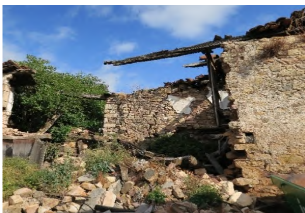
Fachada del ala sur desplomada.
