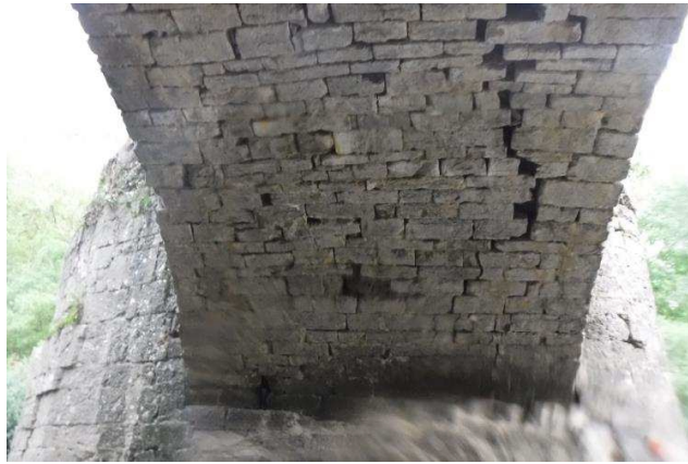
Imagen 4. Pérdida de piezas en la bóveda del vano 1, junto con la pérdida del material de junta.
