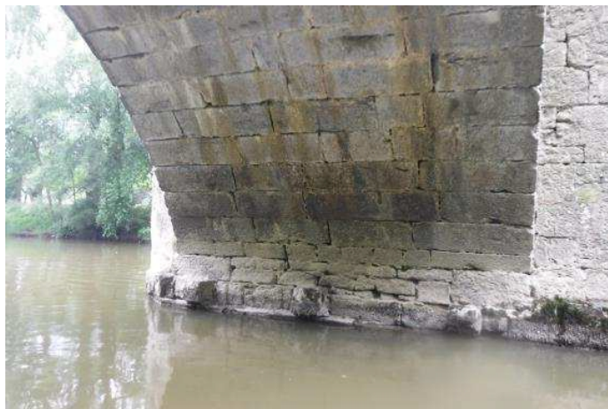
Imagen 6. Manchas de humedad y oscuras, y eflorescencias en las bóvedas.
