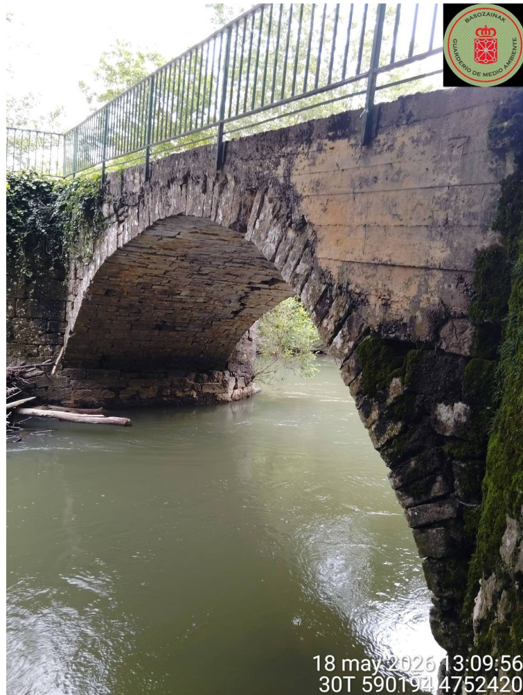
Imagen 12. Detalle del estado actual de los desperfectos y grietas en la bóveda 1 del puente.
