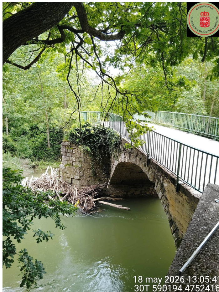
Imagen 11. Estado actual de la bóveda 1 del puente sobre el río Arakil, vista desde aguas arriba.
