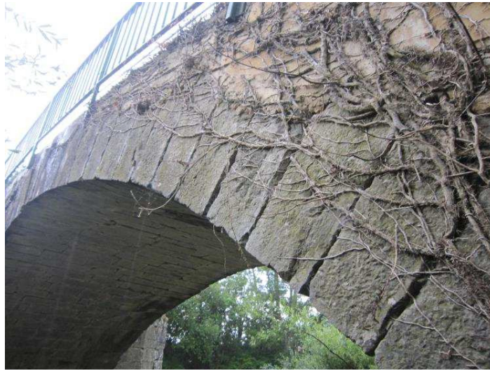
Imagen 10. Vegetación enraizada en la bóveda del vano 2.
