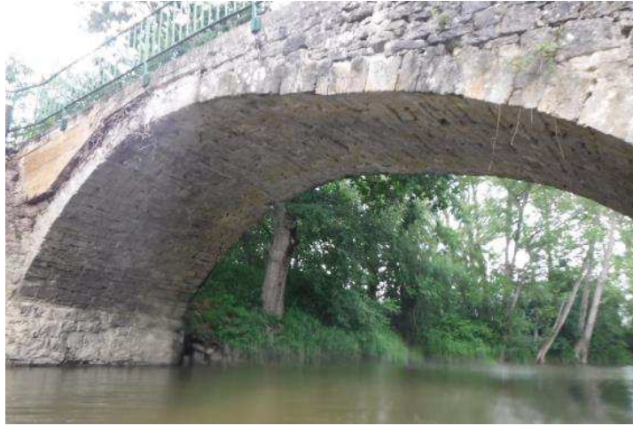
Imagen 7. Deformación de la bóveda 1, junto con la reconstrucción parcial ejecutada en el año 1972.
