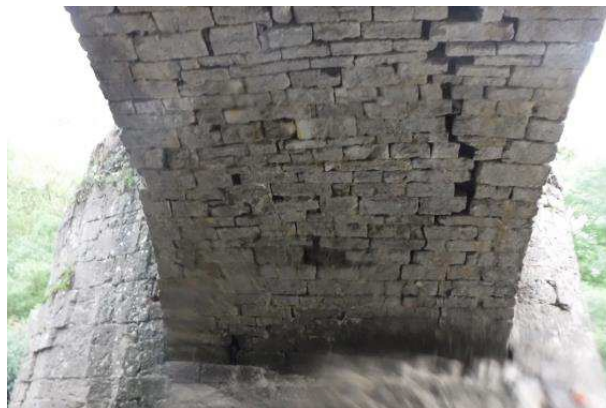
Imagen 8. Primer plano de la grieta longitudinal en cremallera existente en la bóveda 1.
