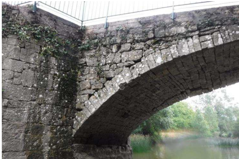
Imagen 5. Pérdida de piezas en los arranques de los tímpanos de la bóveda del vano 1, debido a las deformaciones.
