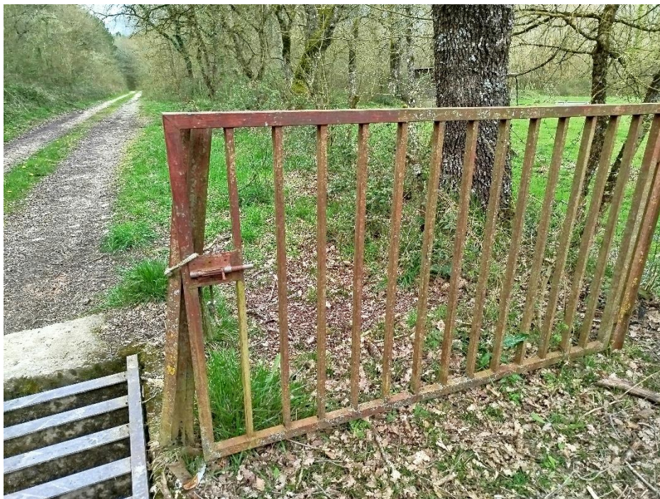
ILUSTRACIÓN 4. ESTADO DE LA PUERTA METÁLICA A SUSTITUIR.
