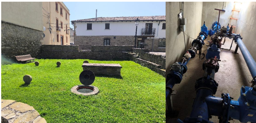
Ilustración 9. Arqueta donde se aloja el contador del sector 3
