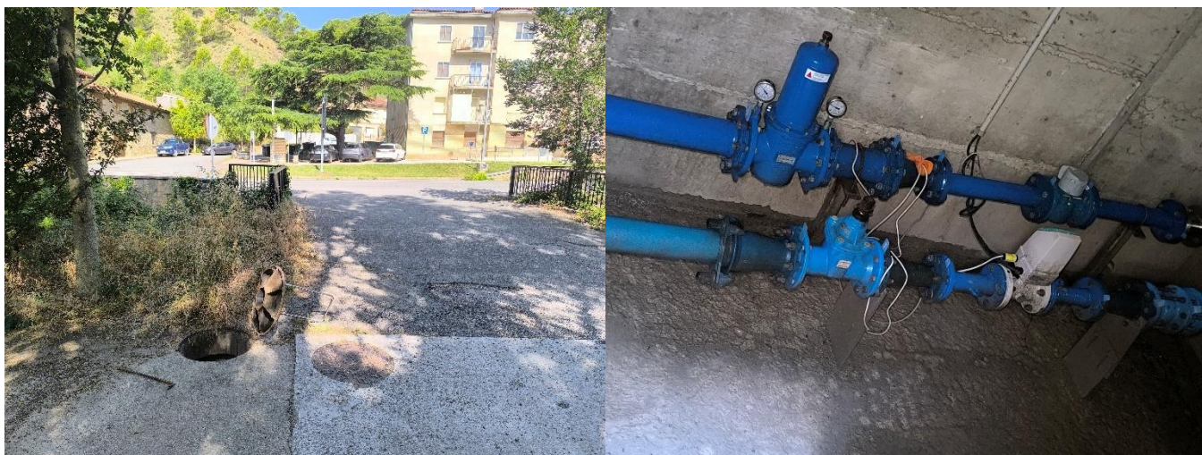
Ilustración 4. Arqueta y tubería que abastece a la localidad de Gabarderal
