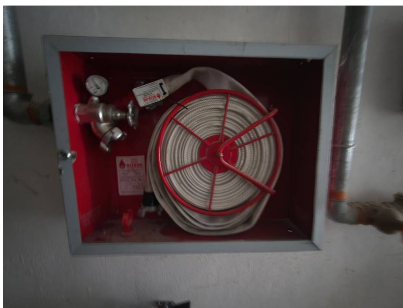
BIE's existentes de 45 mm.
