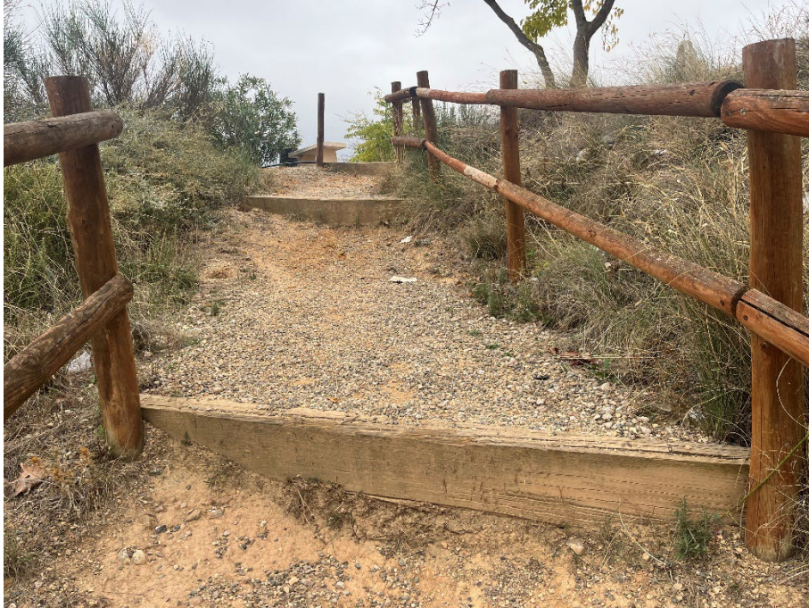
Peldaños de gran altura y ausencia de vallado
