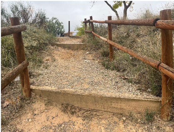
Peldaños de gran altura y falta de vallado
