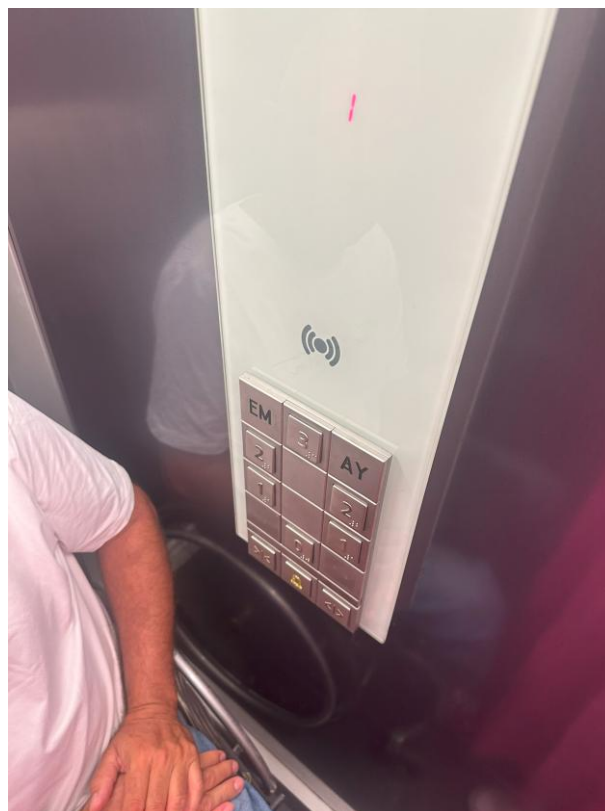
Botonadura interior del ascensor
