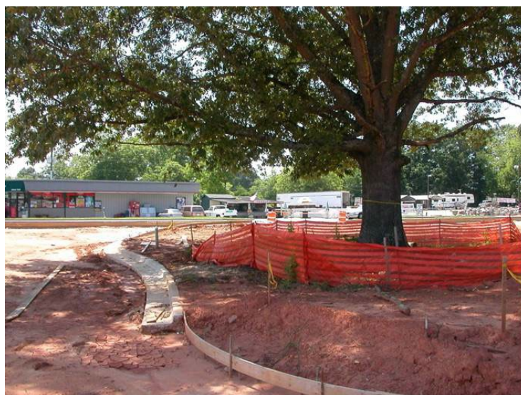
Ejemplo del tipo de protecciones a colocar
