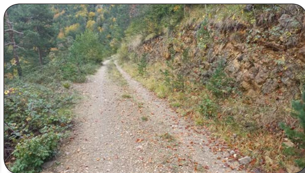
TRAMO 11 (160 ml) Tramo de escasa pendiente carente de cuneta y en aceptable estado. Derrame de materiales del talud de desmonte
