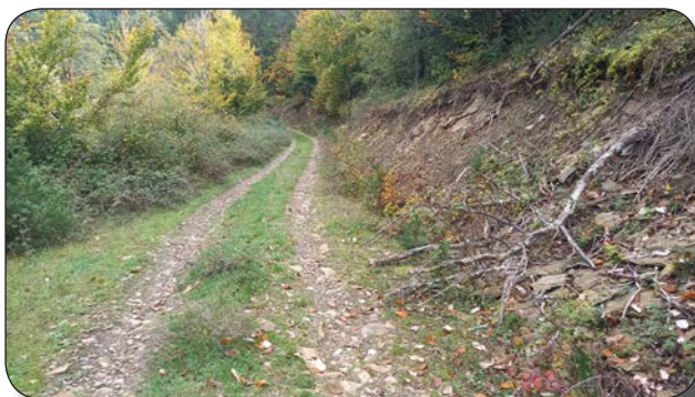
TRAMO 10 (245 ml) Descenso hasta la muga de Roncal donde hay una barrera canadiense. Pequeñas irregularidades y depósitos en cuneta
