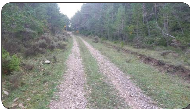
TRAMO 5 (290 ml) Plataforma parcialmente encespedada y algunas acumulaciones en cuneta. Pequeños regueros en la calzada
