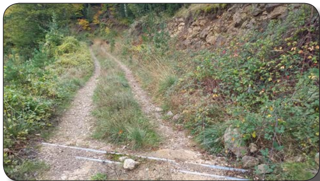
TRAMO 12 (90 ml) Calzada angosta y cuneta casi completamente colmatada
