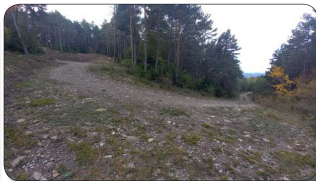
TRAMO 6 (240 ml) Tramo parcialmente repasado hace unos años con cuneta en ambas márgenes. Pocas irregularidades
