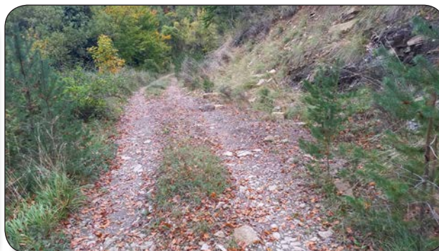
TRAMO 18 (65 ml) Calzada irregular y desprendimiento hacia la cuneta que han terminado por cubrirla por completo
