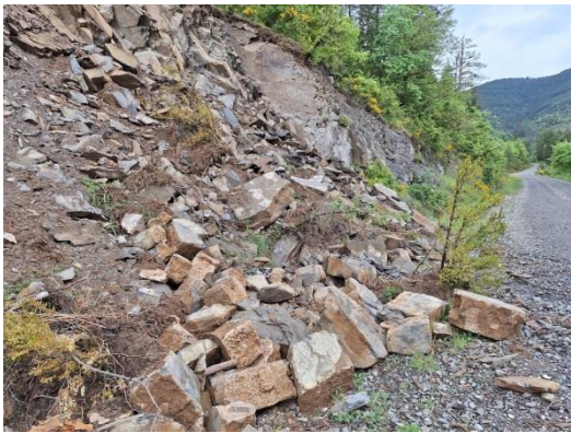
Fotografía 3. Fotografías 1 a 3 deslizamiento pk 1,09.
