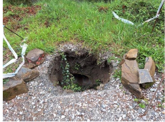
Hueco generado en la plataforma como consecuencia del desplazamiento del tubo. Pk 4,91.
