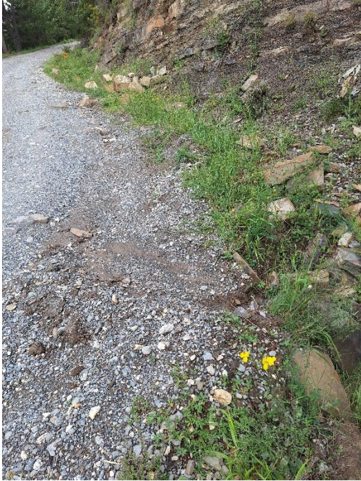
Cuneta colmatada. Pk 3,11.
