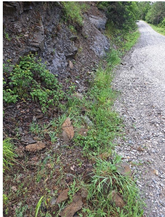
Cuneta colmatada. Pk 1,71.
