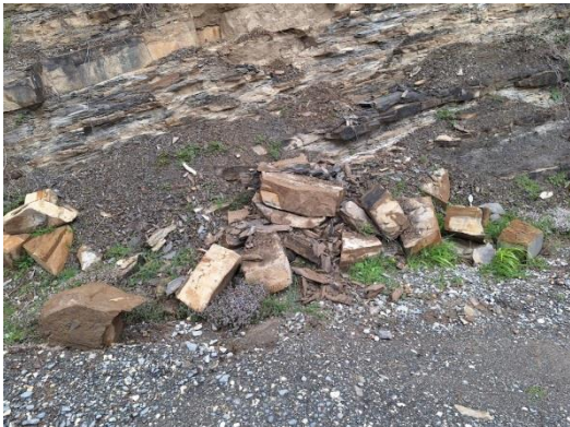
Cuneta colmatada por desprendimientos rocosos. Pk 4,66
