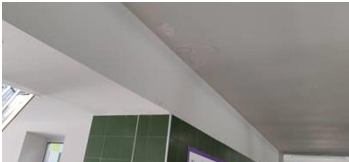
Filtraciones en pasillo de planta inferior
