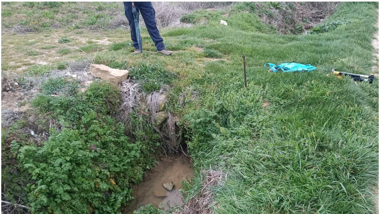
Foto 1. Acceso a huerta donde se ha propuesto ampliar el paso con otro tubo de H de 600 mm
