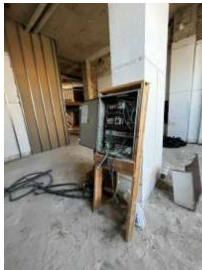
Interior del local. Cuadros eléctricos obra
