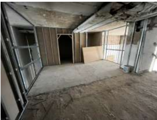
Interior del local. Zona central. Entreplanta Tubos de calefacción central
