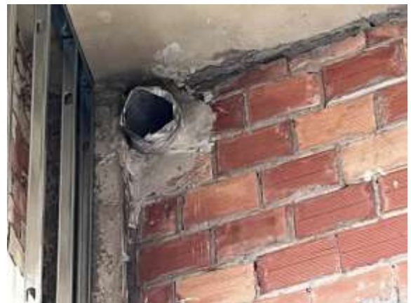
Interior del local. Tubo existente
