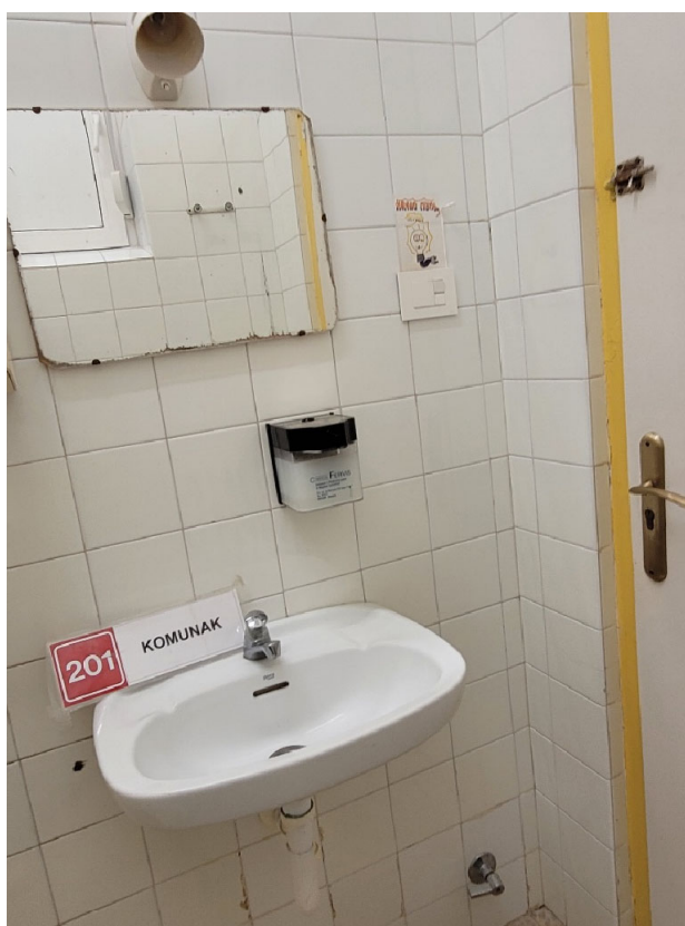
Fotografías 02-04. Aseos para el profesorado. Con deficiencias funcionales y desperfectos de acabados. La anchura de paso de las puertas no garantiza la accesibilidad universal.
