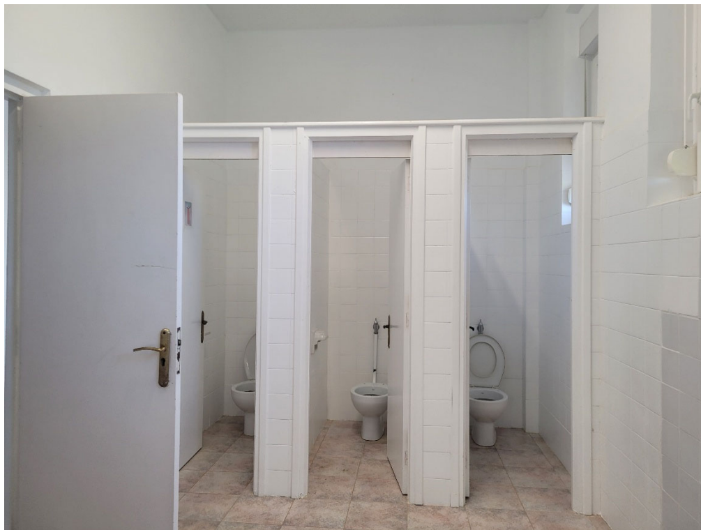
Fotografías 05-09. Aseos para el alumnado. Con deficiencias funcionales y desperfectos de acabados. La anchura de paso de las puertas no garantiza la accesibilidad universal.
