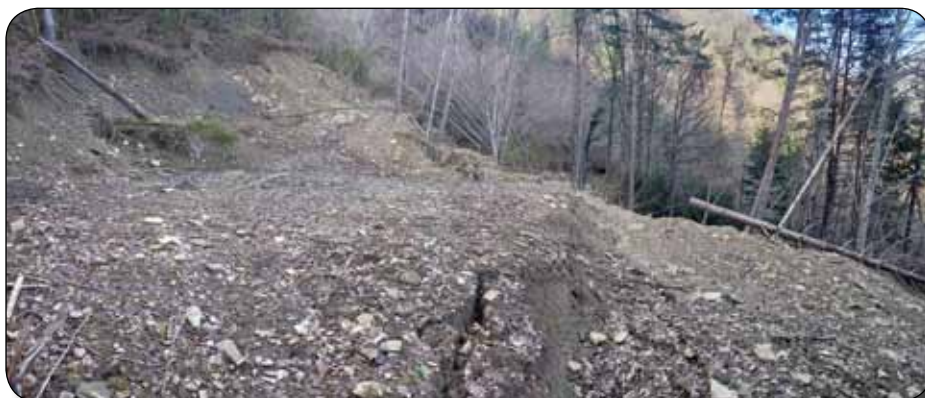
Tramo 3. Curva con asentamiento diferencial severo y derrames del talud de desmonte una vez superada ésta por efecto de surgencias
