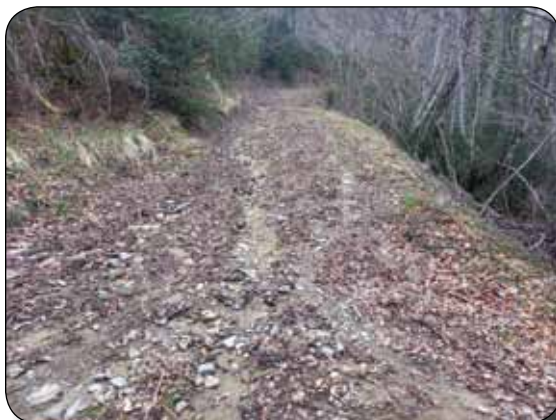
Tramo 2. Arrastres en la calzada por escorrentía
