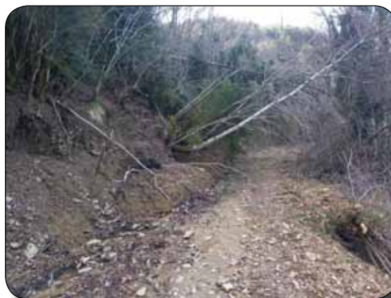
Tramo 2. Derrames del talud de desmonte
