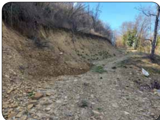
Tramo 1. Derrames del talud de desmonte y aterramiento de drenajes superficiales
