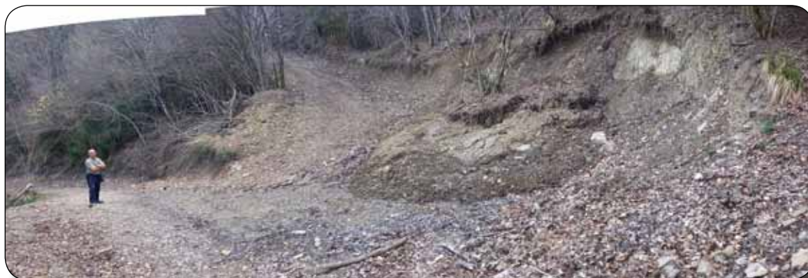
Curva entre tramos 2 y 3. Derrame del talud de desmonte
