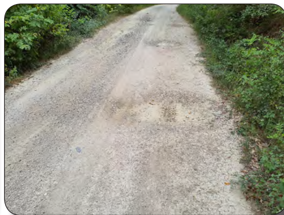
Tramo con baches
