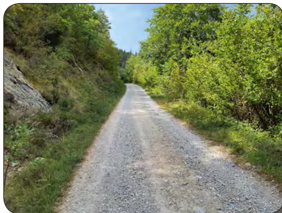
Tramo con pendiente, firme erodado
