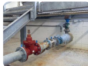
F4 Salida Dep. PI y contador S
