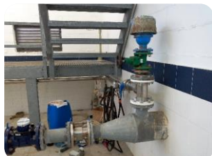
F1 Entrada Dep. PI y contador E
