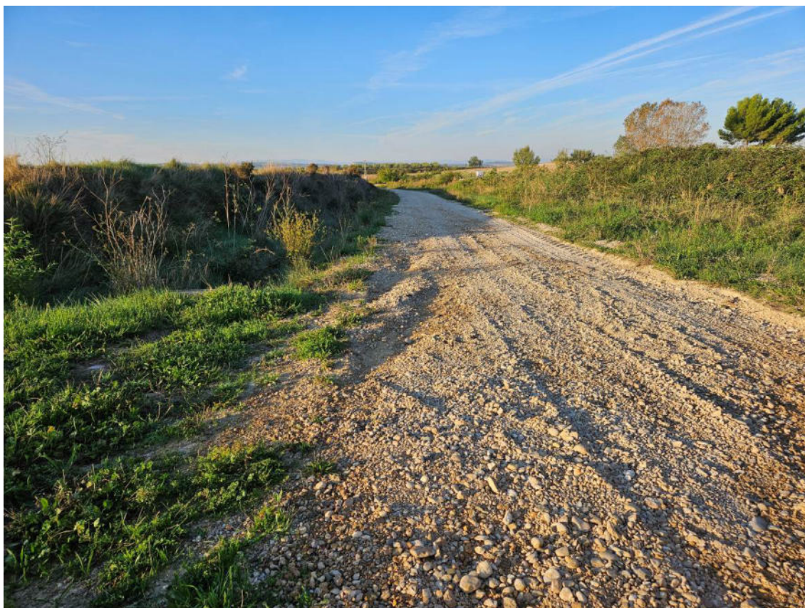
Camino donde la primera riada ha erosionado totalmente la capa de rodadura.
