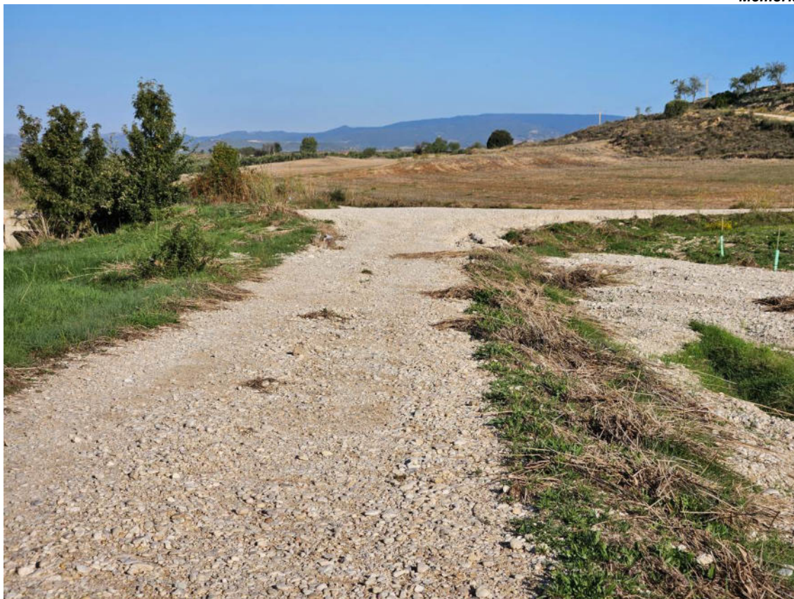
Camino Prado de Roma. Daños graves en la capa de rodadura.
