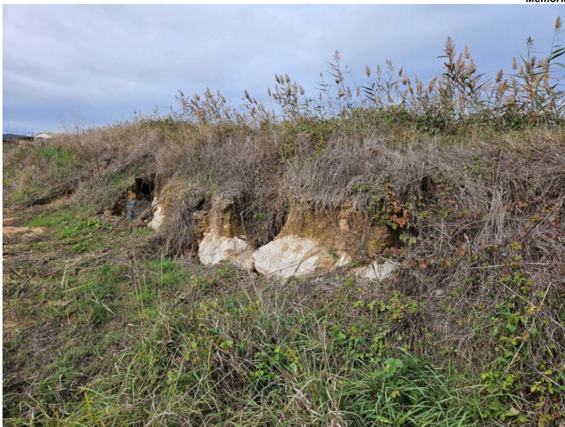
Otra fotografía de la acequia que precisa de desbroce y reparación puntual con tierras de la mota.
