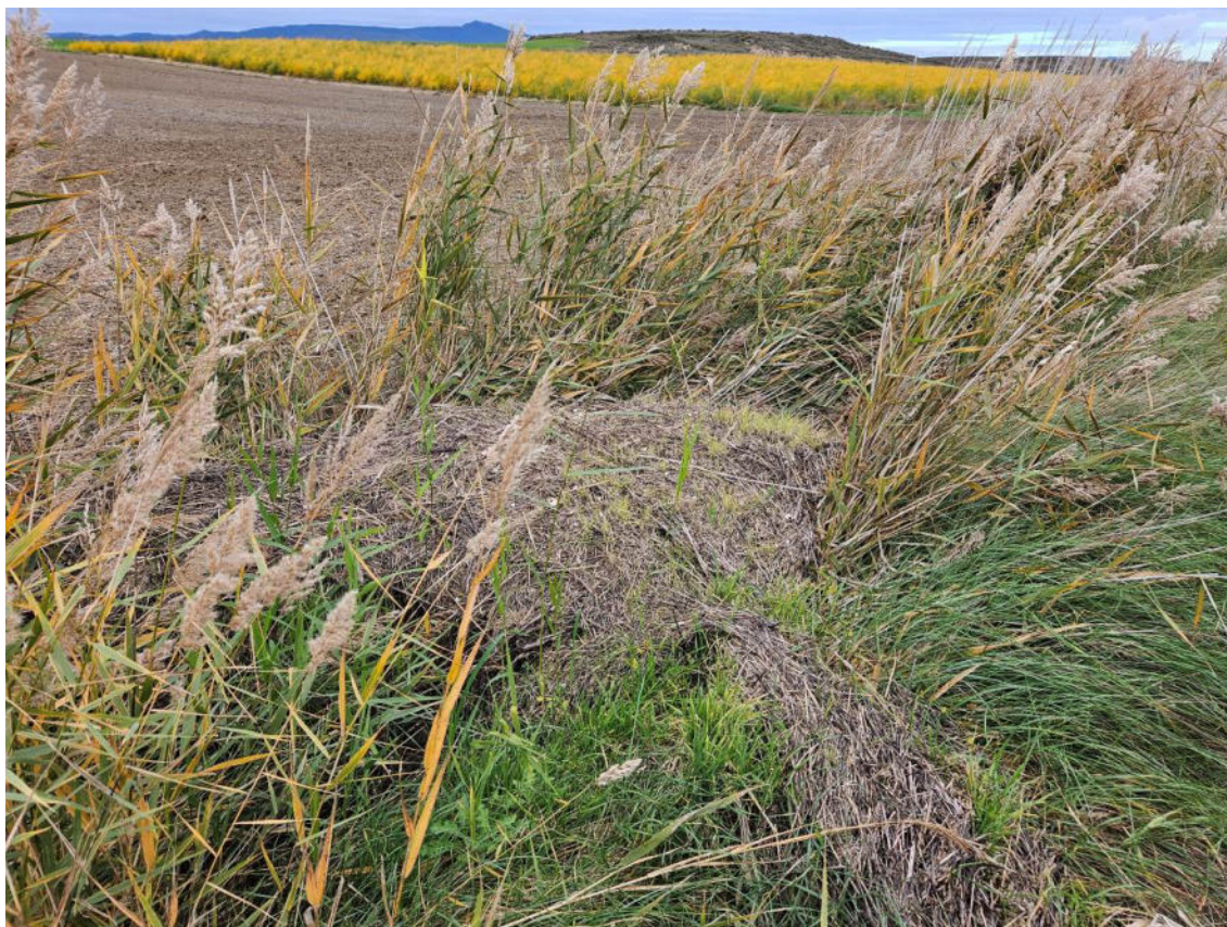
Fotografía de la acequia que precisa de limpieza y perfilado.
