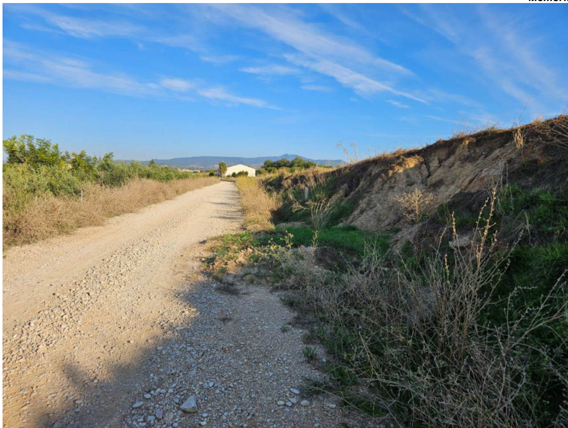
Tramo de 8 ml de desprendimiento
