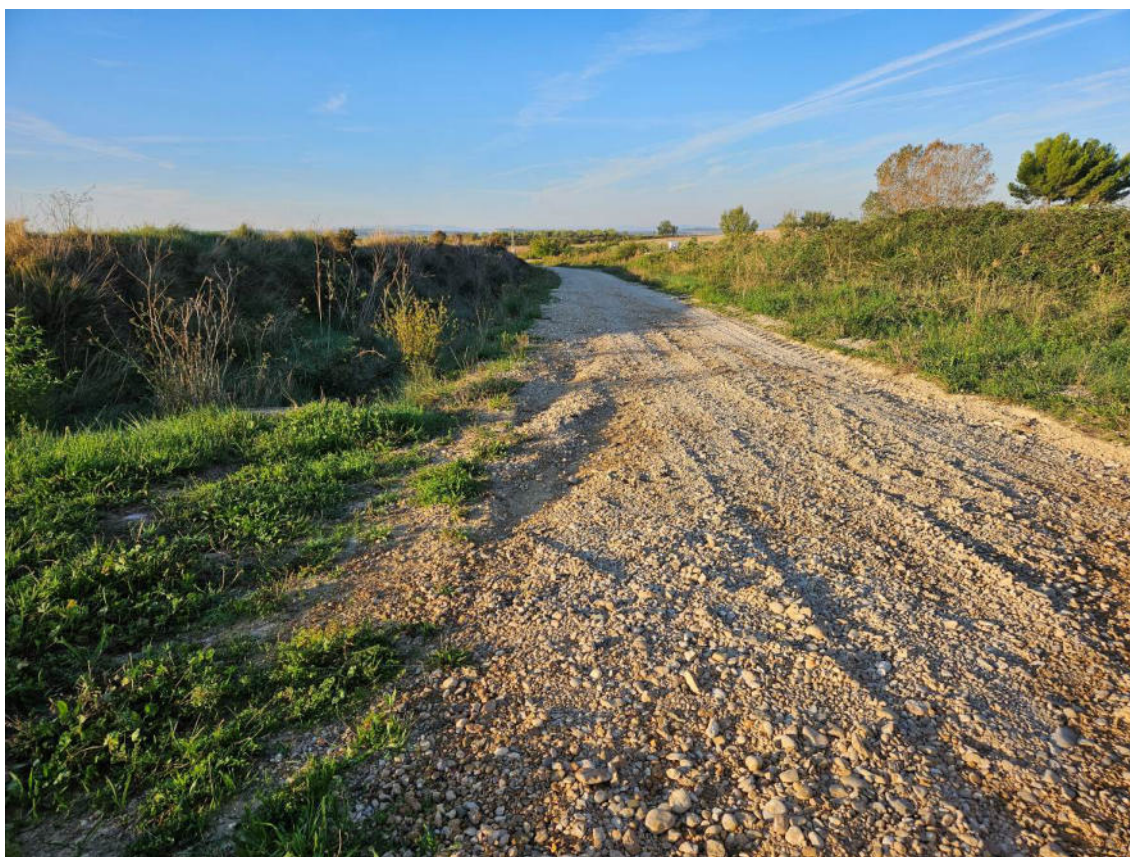
Camino del Monte. Daños graves en la capa de rodadura.
