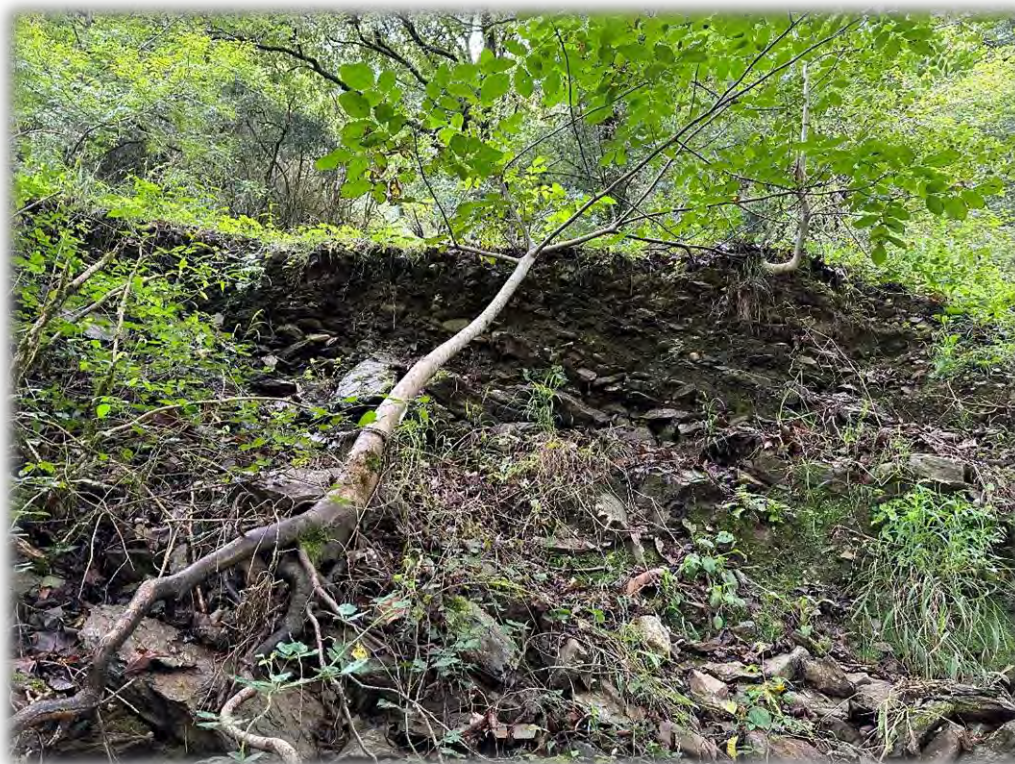
Fotografía 7: Talud erosionado por el río Bidasoa.
