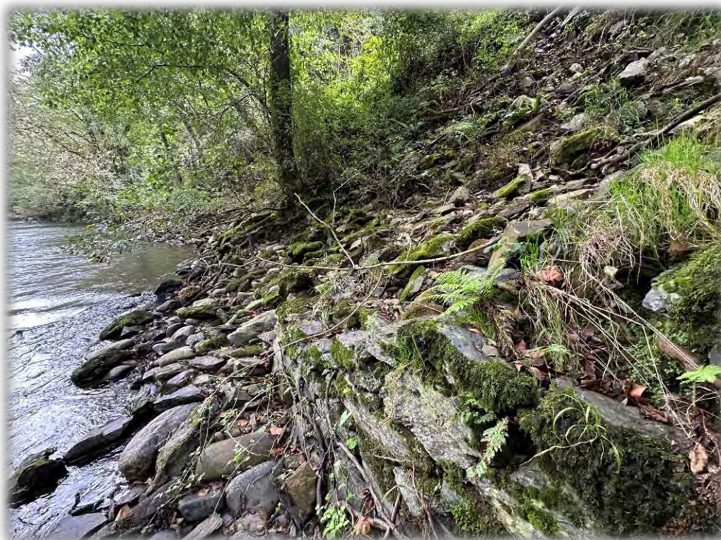
Fotografía 5: Vista de la desaparición del muro de mampostería, mirando aguas arriba.
