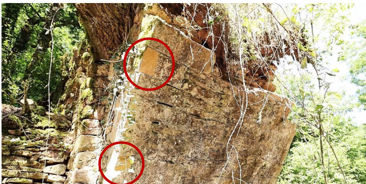
Fotografía con la falta de material por exceso de compresión en los vértices de las dovelas de la rosca del arco.
