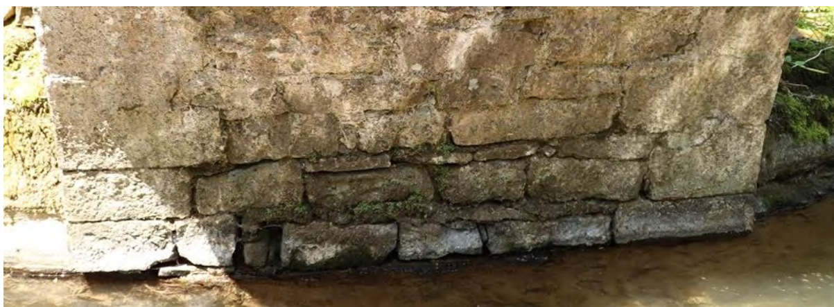
Fotografías donde se ve la falta de rejuntado en las primeras hiladas. Arriba: margen izquierda. Abajo: margen derecha.
