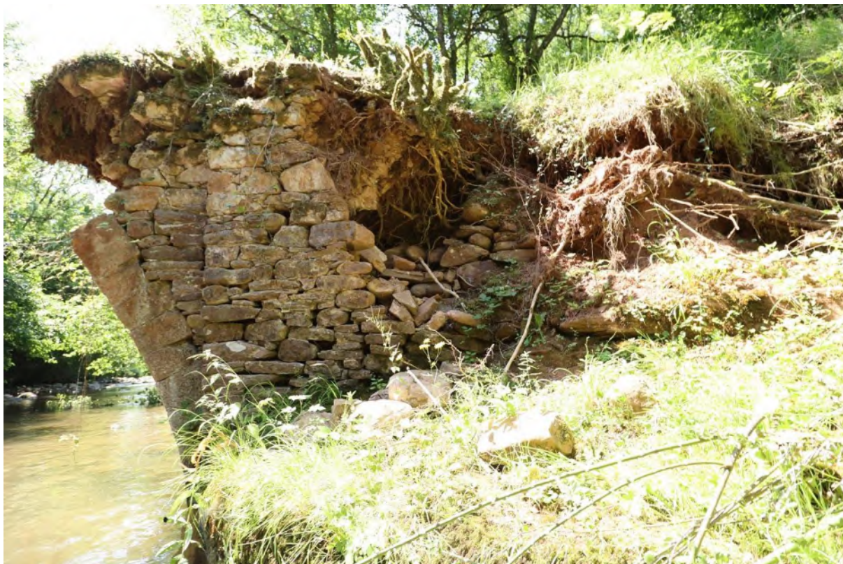
Fotografía que muestra el derrumbe del muro de la aleta de la margen derecha aguas arriba.
