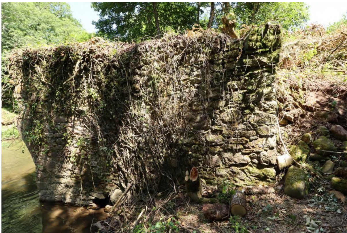
Fotografía de la enredadera en el muro de la aleta de la margen izquierda aguas arriba de los restos del puente.
