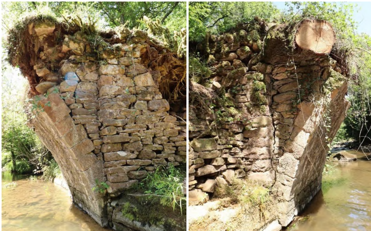
Imágenes que muestran las grietas entre rosca y tímpano y entre arco y estribo. Izquierda: aguas arriba. Derecha: aguas abajo.
