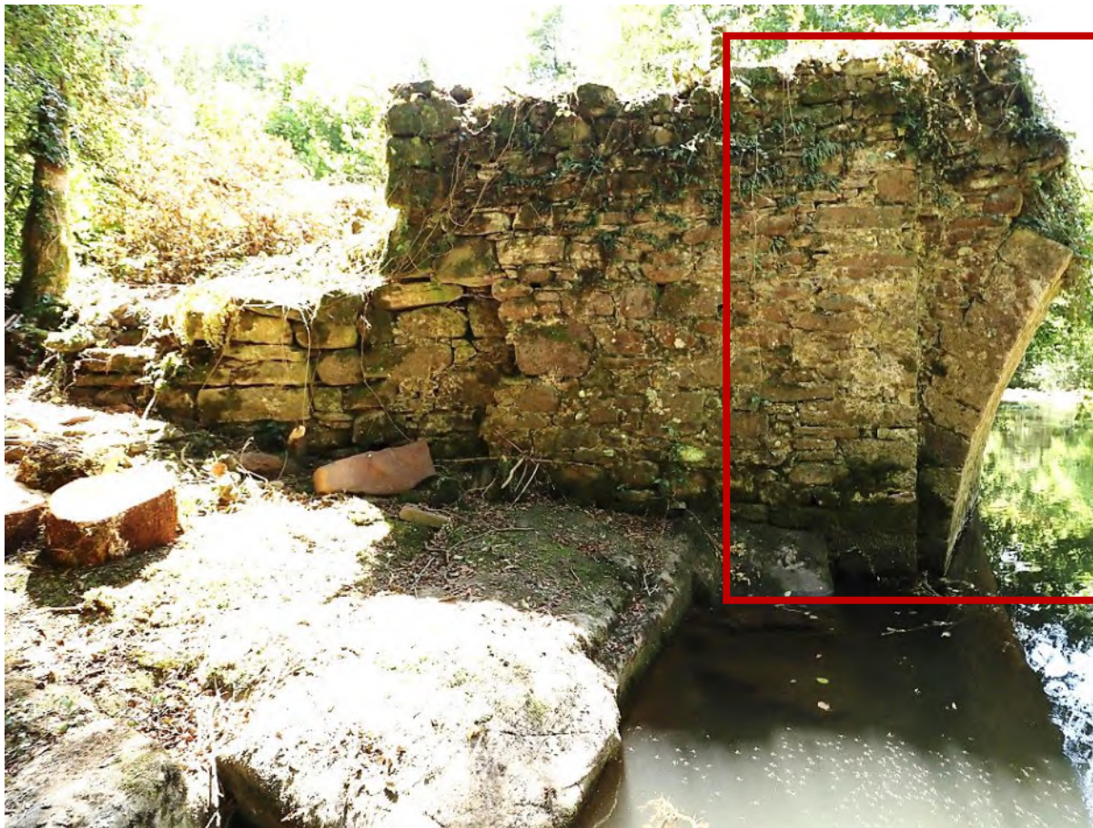
Fotografía en la que se aprecia una grieta entre la rosca y el tímpano y en la esquina del estribo, con reparaciones de mortero.
