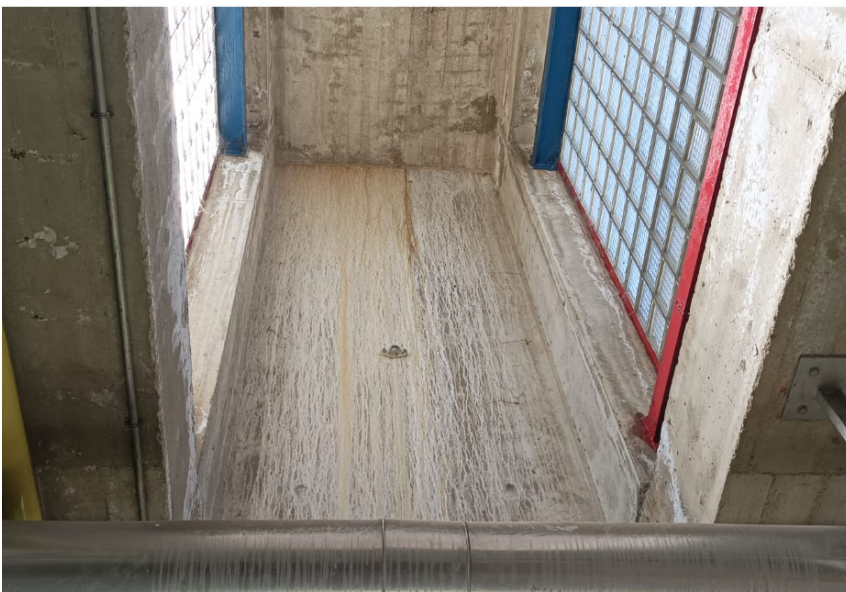
FILTRACIONES EN CUBIERTA
