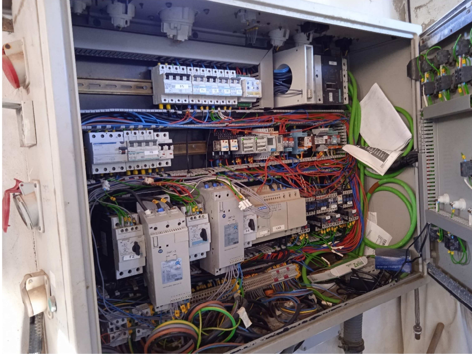
INTERIOR CUADRO ELECTRICO
