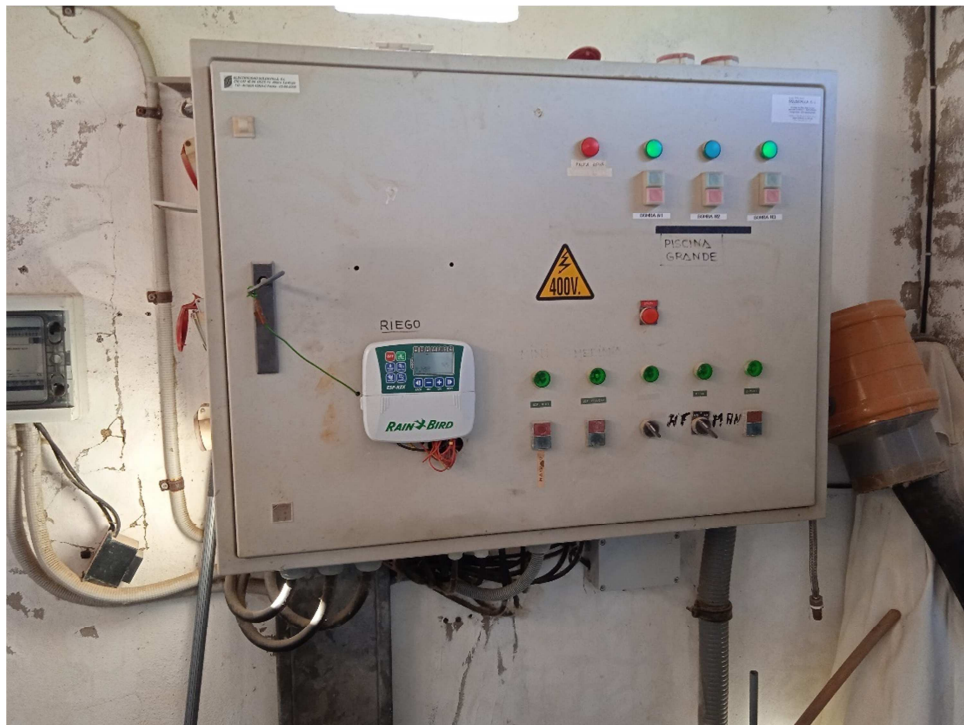
EXTERIOR CUADRO ELECTRICO
