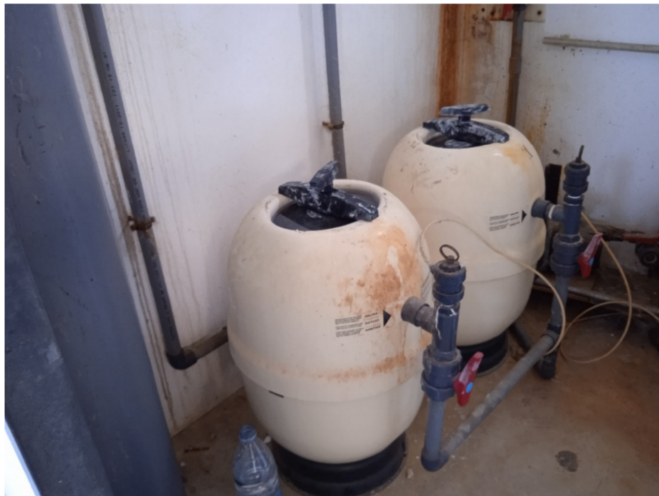
EQUIPOS DOSIFICACION PASTILLAS CLORO
