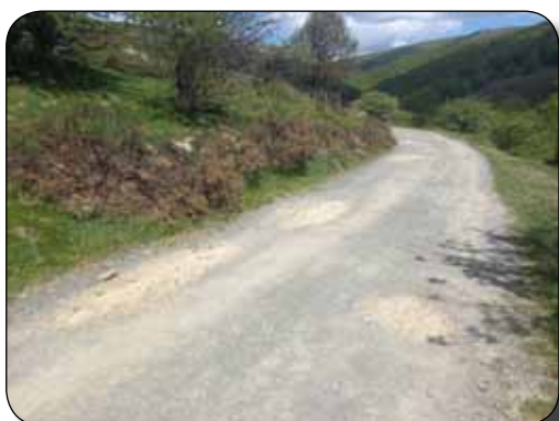
Baches en tramo llano
