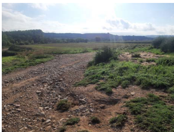
Vista de los desperfectos en el cruce.
