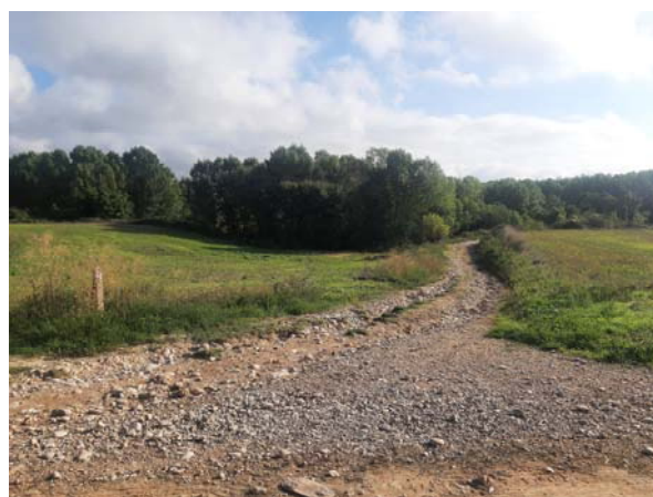
Vista de los desperfectos en el camino de servicio..
