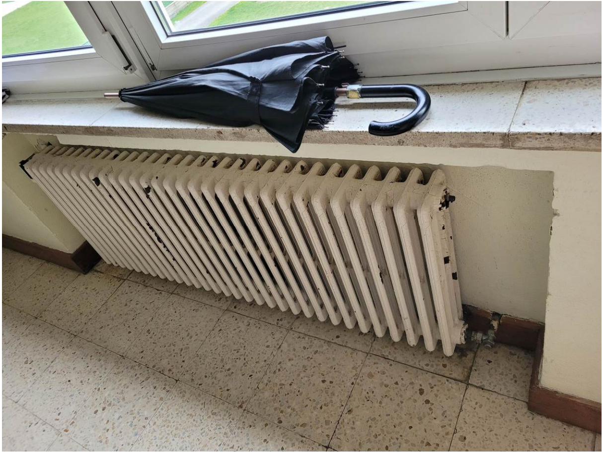
Fotografía 11. Deficiencias en elementos de calefacción.
