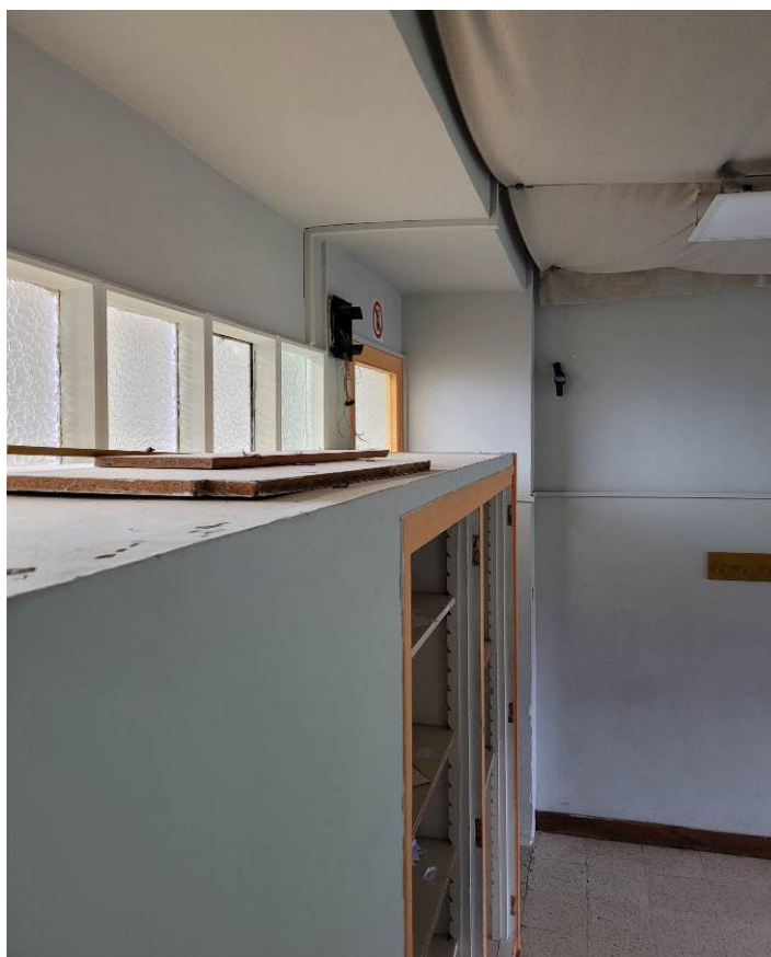
Fotografías 07-10. Aulas con problemas de aislamiento térmico y acústico, carencias funcionales importantes, acabados irregulares, problemas de sobrecalentamiento por soleamiento, iluminación y electricidad, etc.
