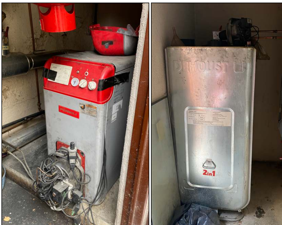
Detalle caldera actual y depósito de gasóleo.
