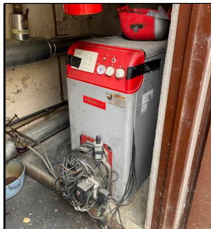
Imagen. Caldera de gasóleo (a retirar)
