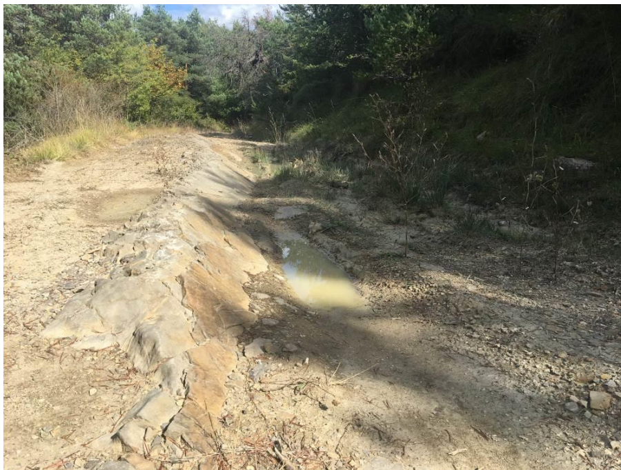
Imagen 5. Tramo en el que los encharcamientos son habituales con importante desnivel provocado por el lavado del material dejando una veta de roca en superficie.
