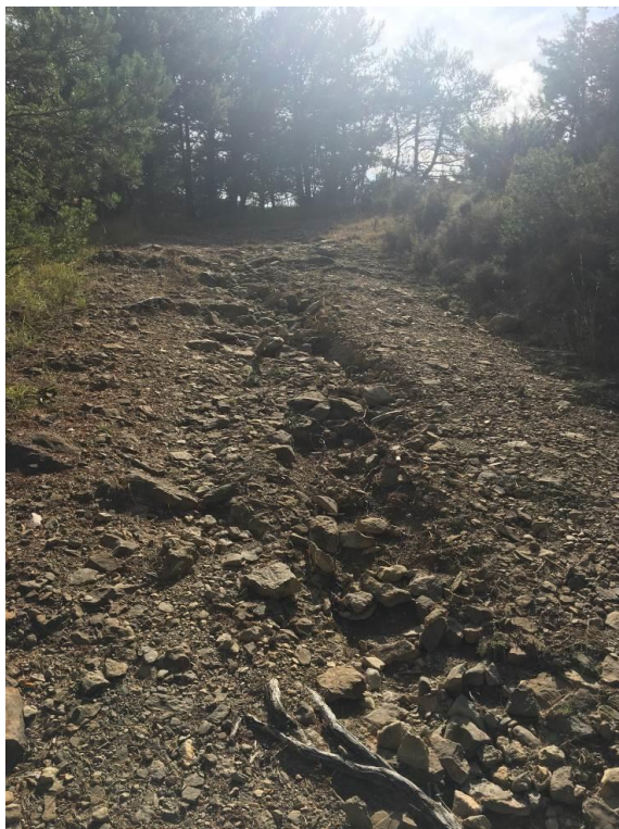
Imagen 7. Tramo en el que es evidente la formación de regueros por el efecto erosivo del agua.
