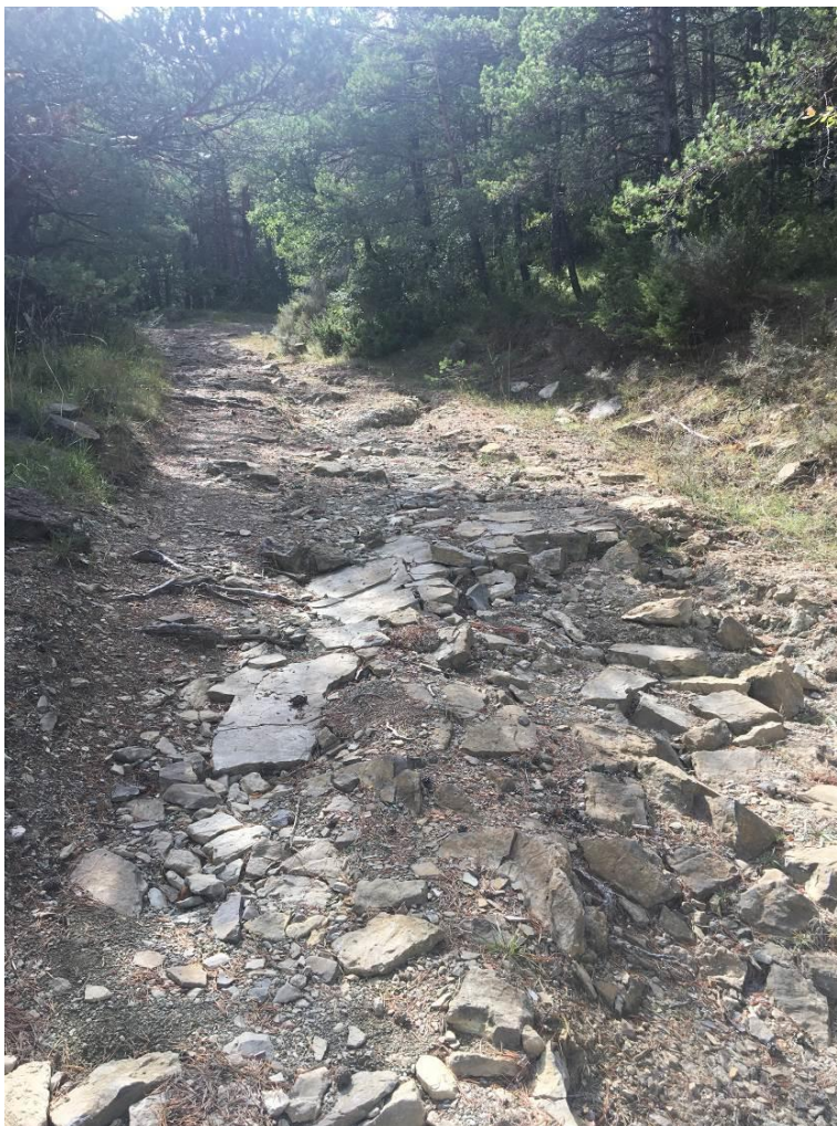
Imagen 2. Estado de uno de los tramos de la pista en el que afloran los elementos rocosos.
