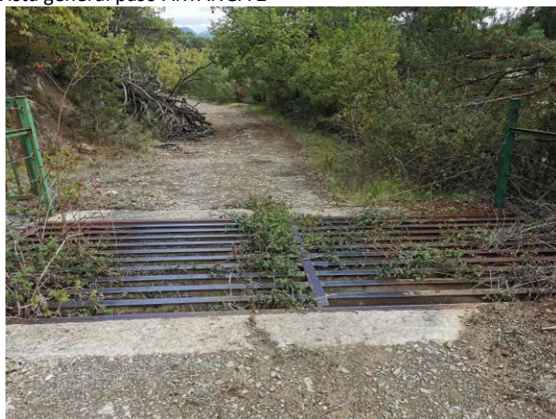
Detalle vegetación instalada en el fondo del paso.
