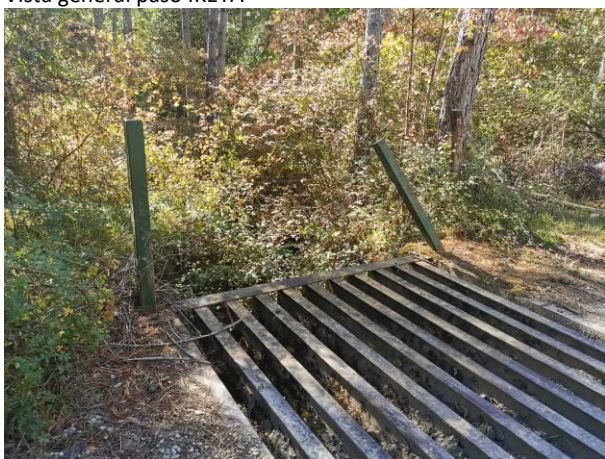
Detalle de poste a enderezar
