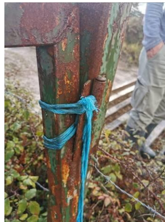
Bisagras a sustituir y nivelas portillo
