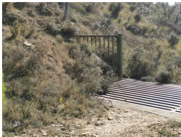
Detalle paso IZANOZ 3 corrimiento de tierras sobre portillo
