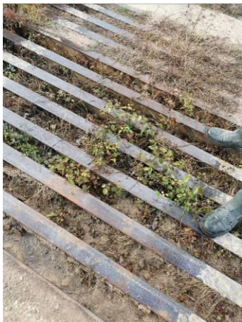
Estado colmatación del paso
