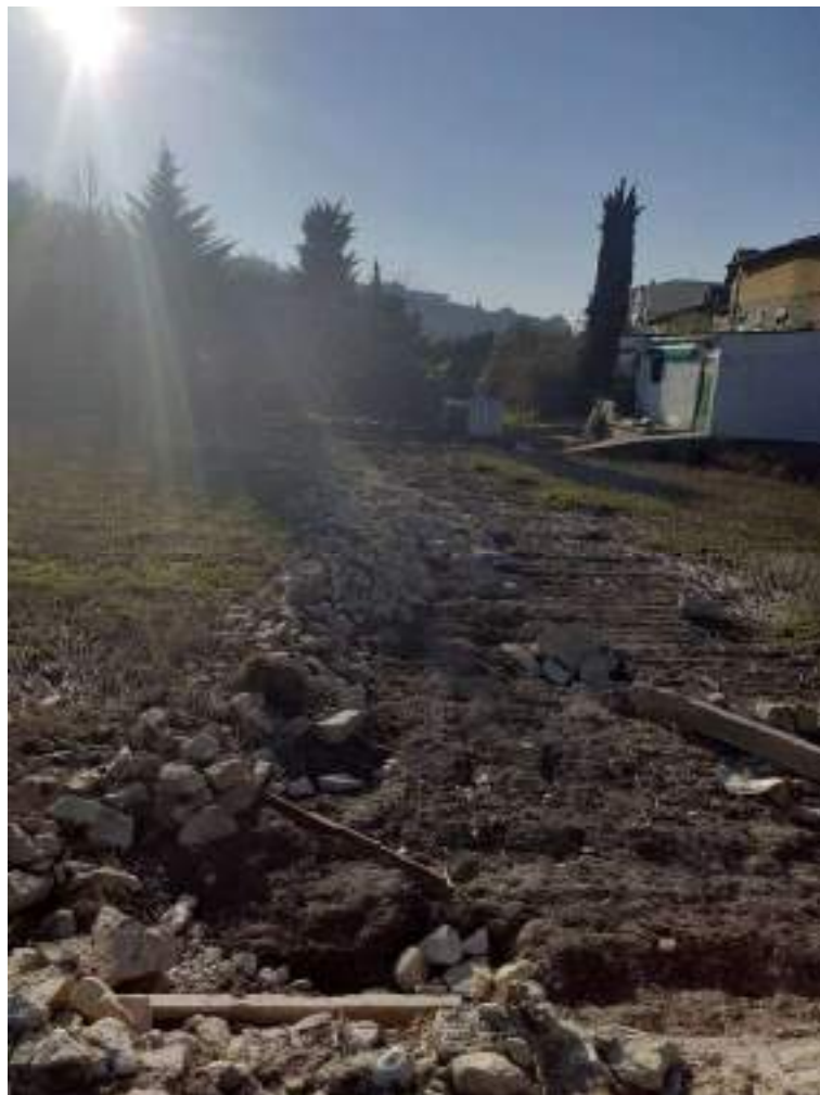
Foto 22: Erosión de terreno en forma de canal tras el derrumbe del muro de piedra anterior.
