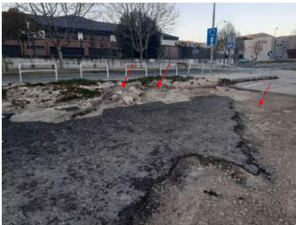
Foto 18: Erosión del firme de pavimento asfáltico del aparcamiento de Santa Bárbara.
