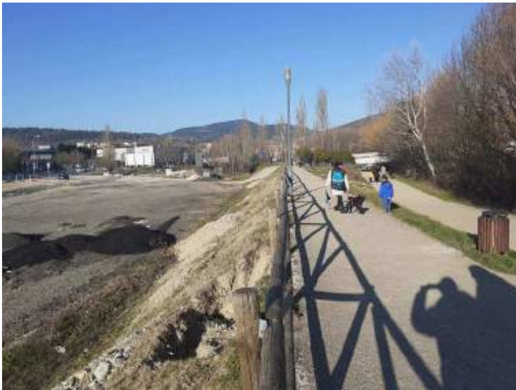
Foto 17: Erosiones en el talud de la mota por el agua desbordada entre el puente de Areta y el parque de La Nogalera. La presencia de este tipo de erosiones indica la existencia de niveles diferenciados de agua a uno y otro lado de la mota.
