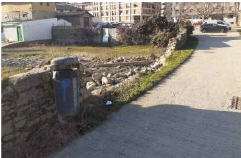
Foto 21: Muro de piedra de mampostería derrumbado por las aguas.
