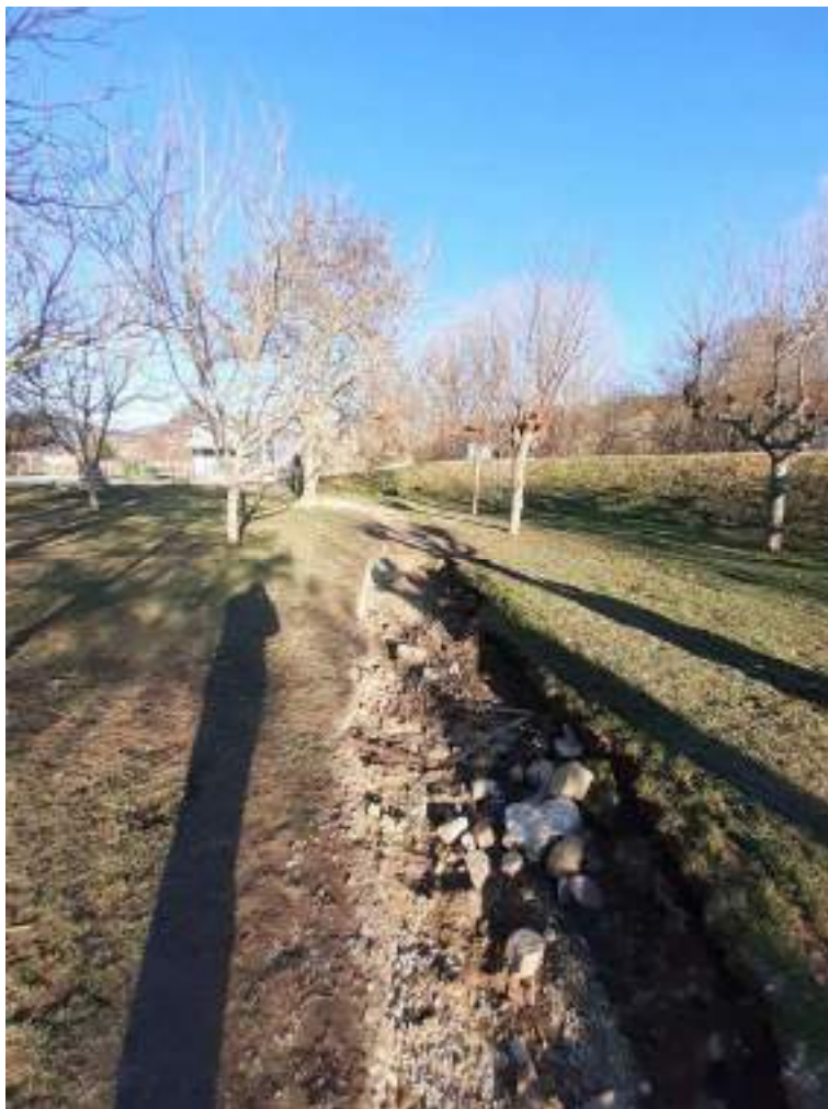
Foto 23: Erosiones en parque de La Nogalera asociadas a la presencia de la zanja de un colector.
