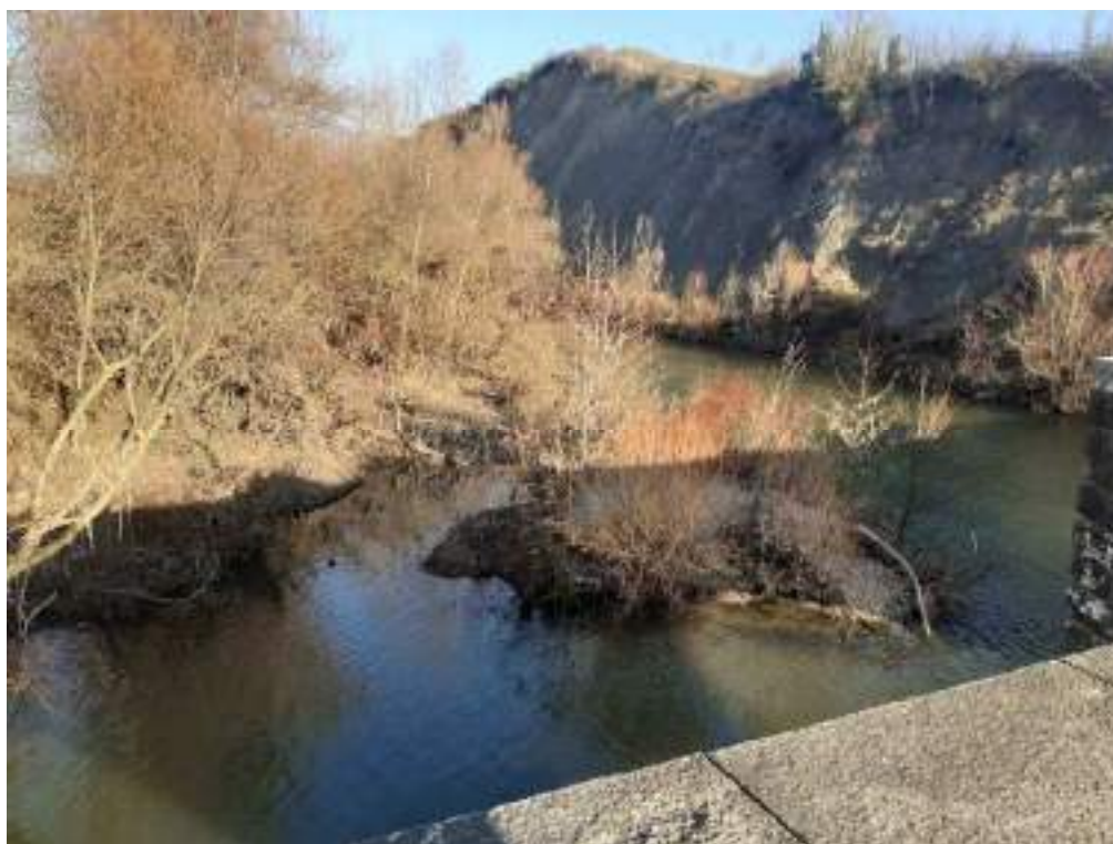
Foto 4: Islas de depósitos aluviales con crecimiento de vegetación que apantallan los dos vanos derechos del puente Viejo de Burlada (aguas arriba).
