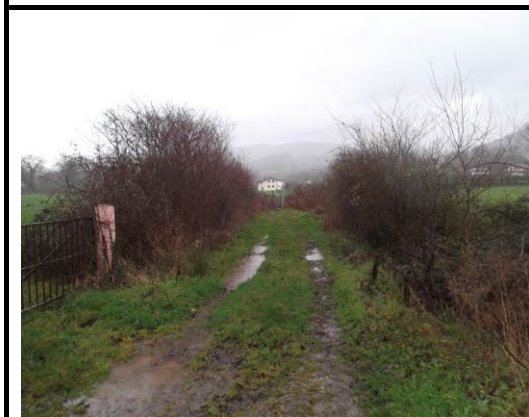
74. Camino antigua vía. Problemas encharcamientos.
