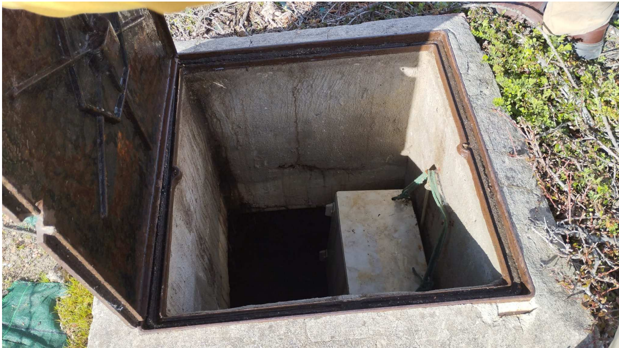
Fig. 4. Vista detalle arqueta eléctrica
