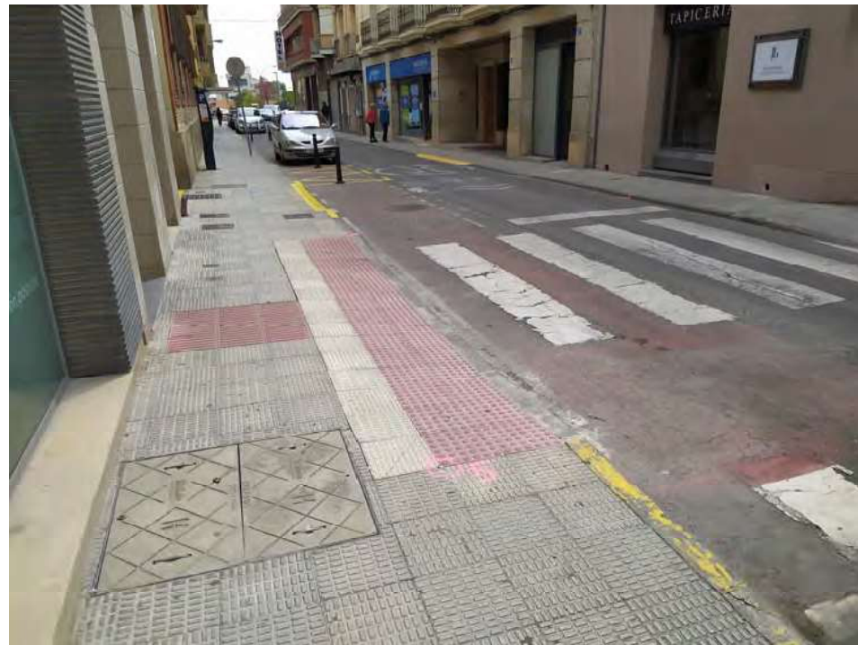
Estado pavimentos calle San Marcial
