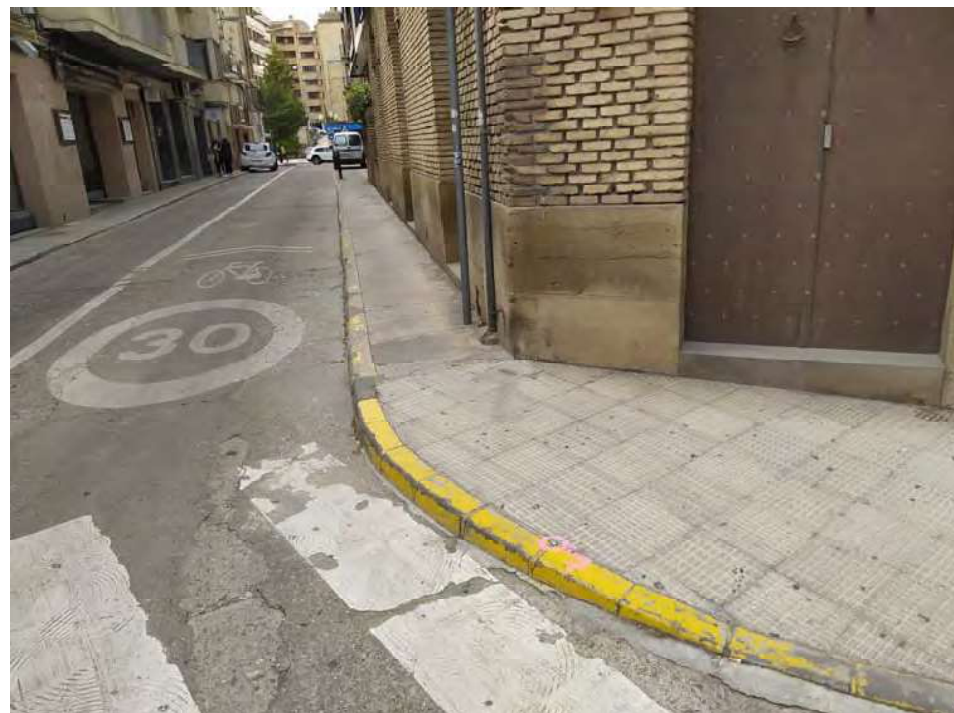
Estado pavimentos calle Barrio Verde
