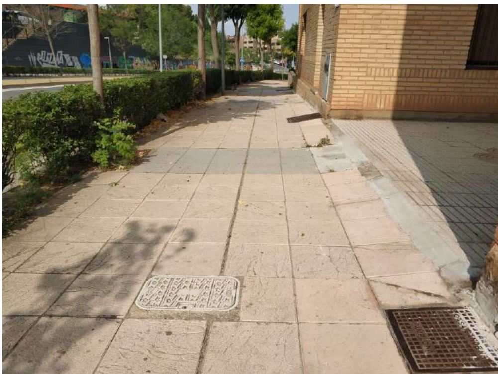
Acera “descolgada” de frente de edificio. Se plantea picar y levantar baldosas, excavar, sanear, rellenar, compactar, nivelar, impermeabilizar muro de la edificación y repavimentar.
