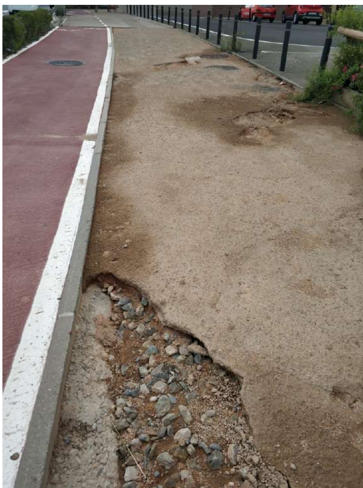
Estado actual de una zona de acera.
