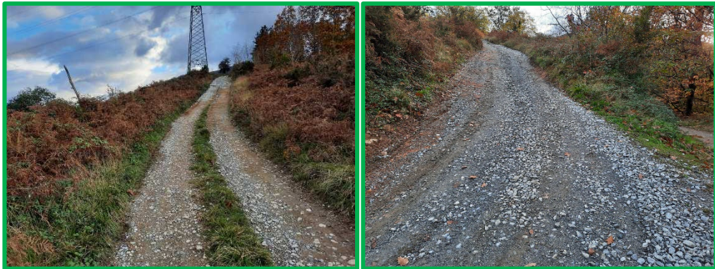
Tramos en mal estado
