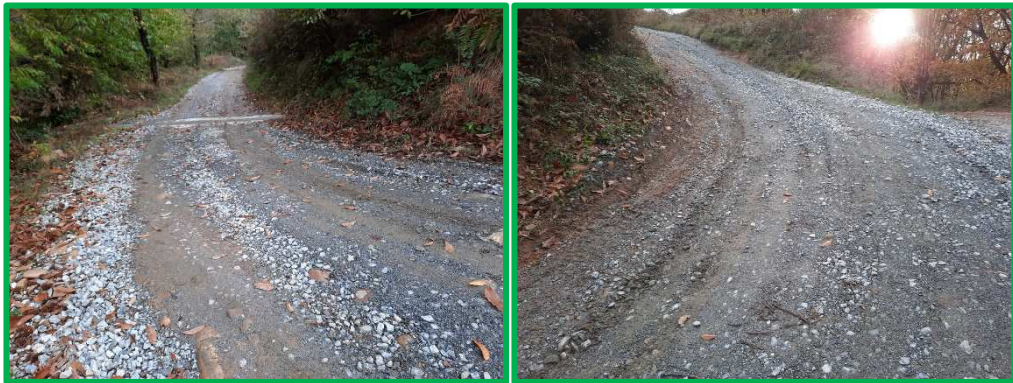
Tramos en curva en mal estado
