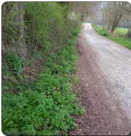
Cuneta casi colmatada
