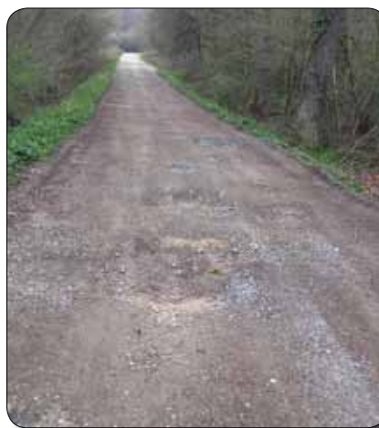
Concentración de baches
