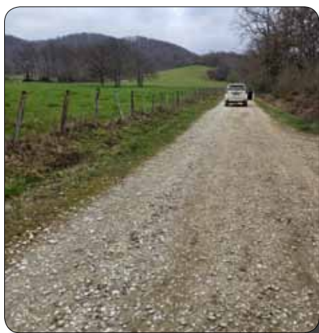
Firme irregular y cuneta colmatada parcialmente
