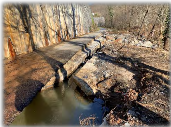
Fotografía 19: Daño en la plataforma de la Vía Verde.
