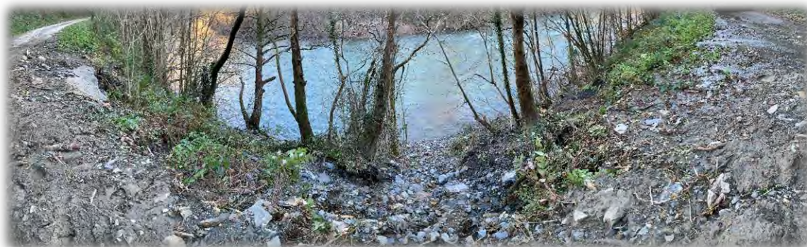
Fotografía 15: Talud de sujeción dañado por regata.
