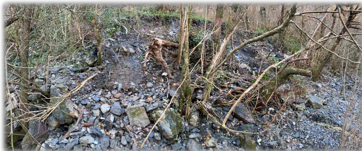
Fotografía 17: Talud de sujeción dañado por regata.
