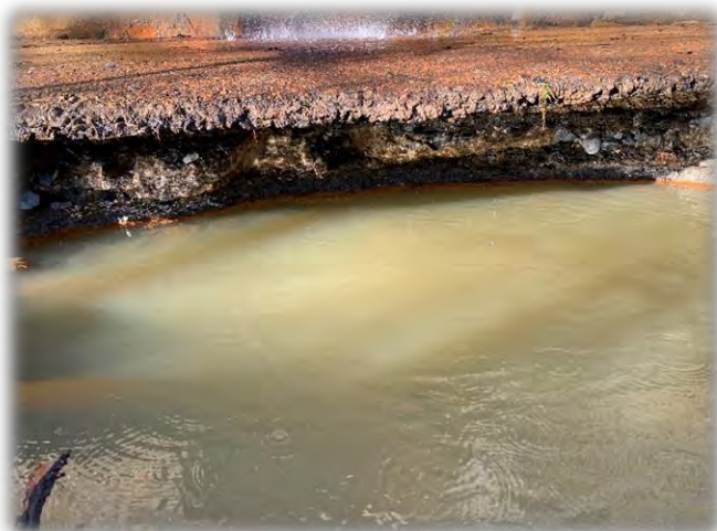
Fotografía 18: Daño en la plataforma de la Vía Verde.
