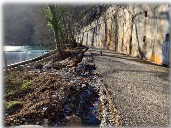
Fotografía 20: Daño en la plataforma de la Vía Verde.
