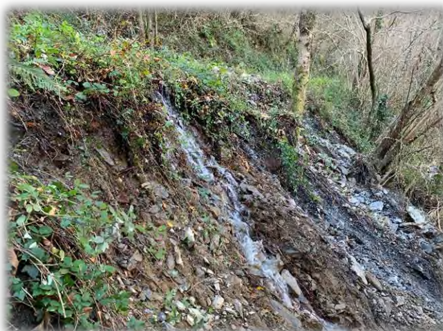
Fotografía 16: Talud de sujeción dañado por regata.
