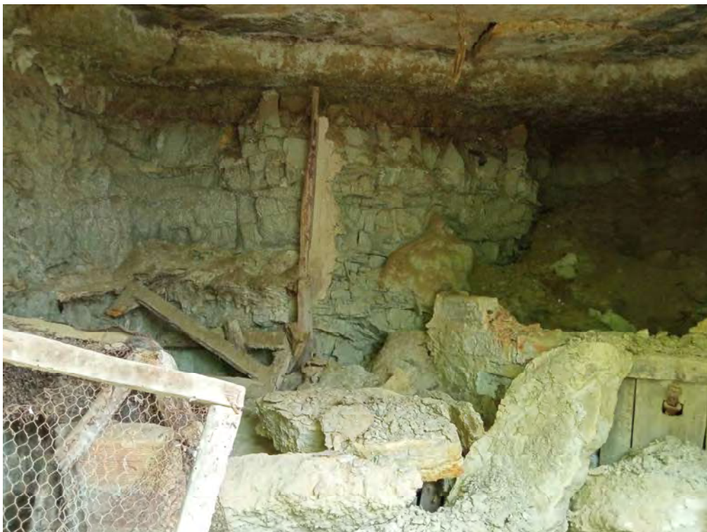
Cueva semiderrumbada en parcela 14. Se observa la roca subhorizontal en las paredes y el techo, de donde se ha desprendido parte del estrato que lo formaba.
