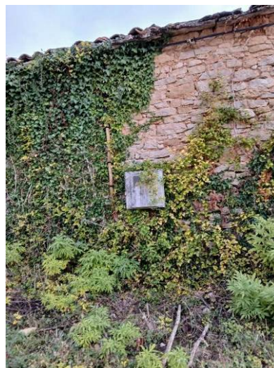
Actual punto de suministro 13,2 Kw
