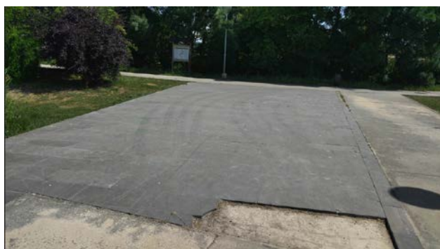
Estado del pavimento de piedra.
