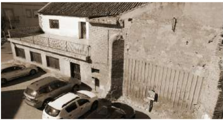
P1. PATOLOGÍAS EN CUERPO ESTE
