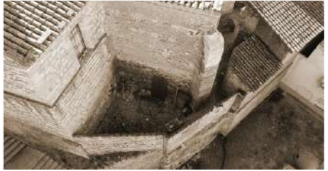
P2. LATERAL CON DESPRENDIMIENTO DE MATERIAL ORIGINAL
