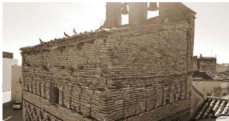
P1. TORRE Y CUBIERTA DETERIORADA
