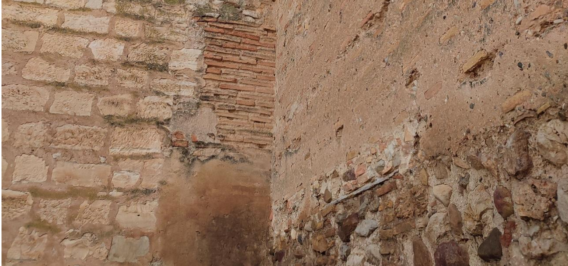
Tapia valenciana, calicostrada en deterioro de la cara Norte de la Crujía Oeste.
