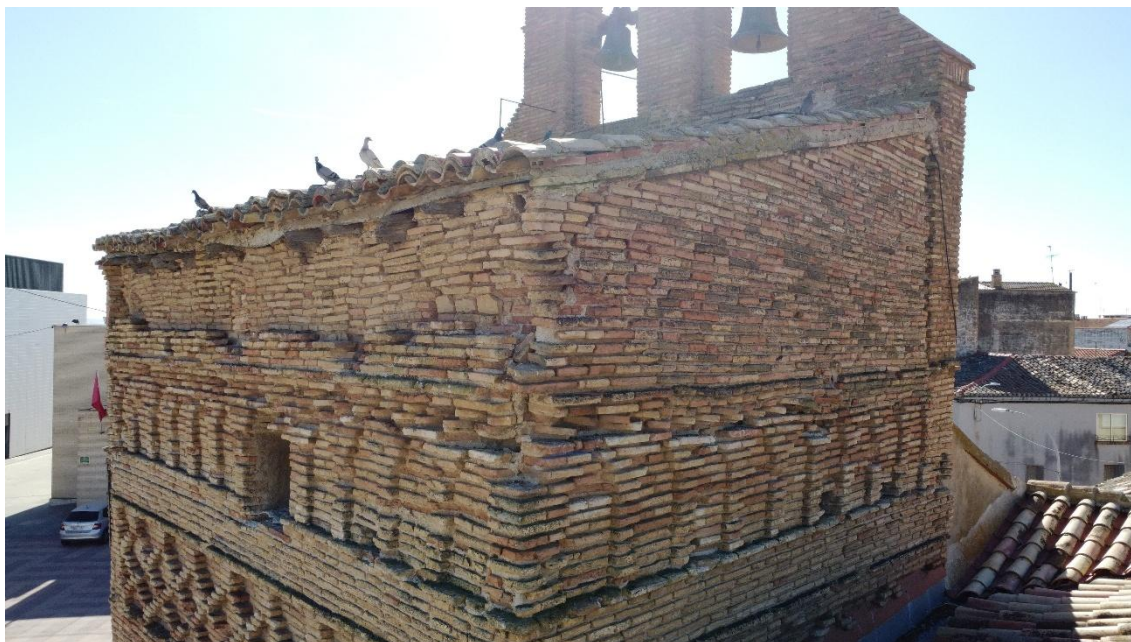
Estado actual. Esquina Noreste. Hojas incompletas e inestables en planta bajocubierta.
