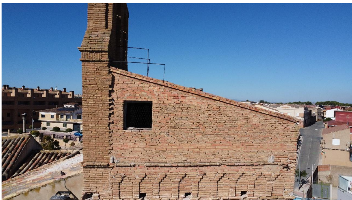
Estado actual. Alzado Este. Grieta en espadaña.
