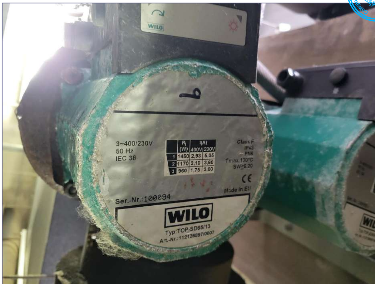
Fotografía 2 Bomba de distribución del frío existente a ser sustituida.
