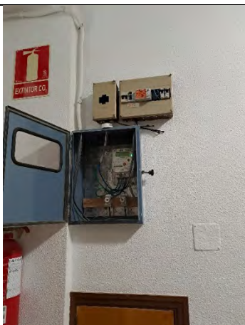
Foto 03: Cuadro eléctrico y contador del edificio
