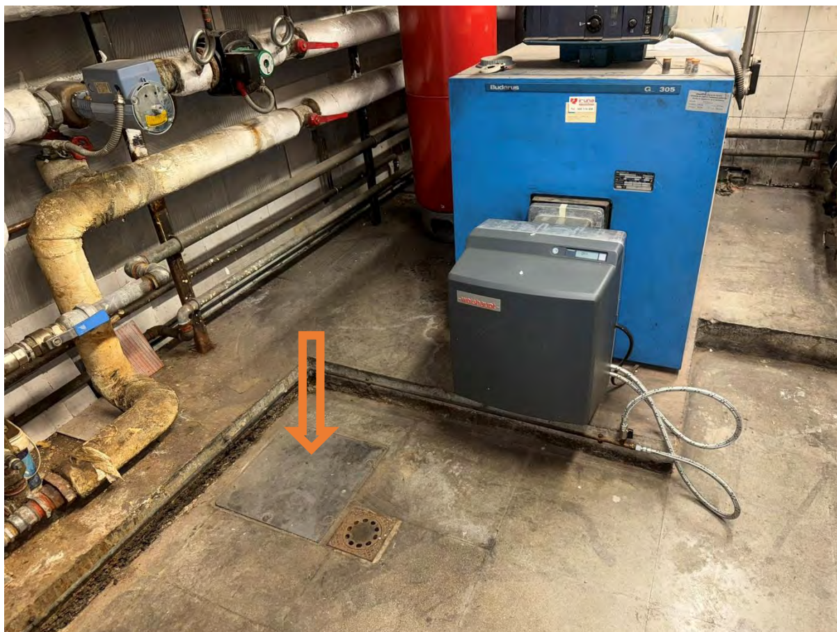
Arqueta de saneamiento en sala de calderas.
