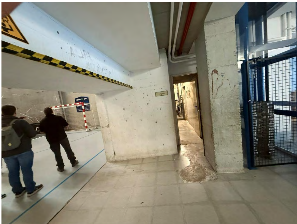
Frontón en planta semisótano: corredor junto a la cancha, bajo las gradas. En el centro, la puerta de la sala de calderas; entre el poste y la cancha se van a instalar los depósitos de inercia y expansión.
