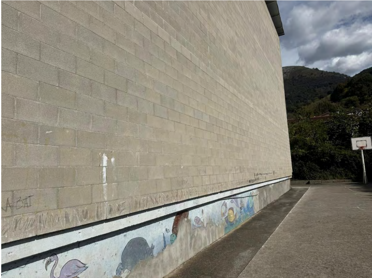
Fachada sureste. Las unidades exteriores se ubican contra esta.
