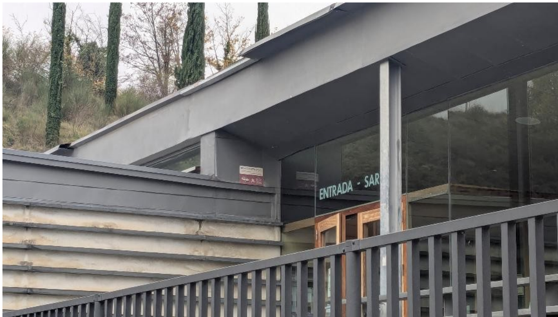
Desprendimiento del pequeño alero provocado por el viento
