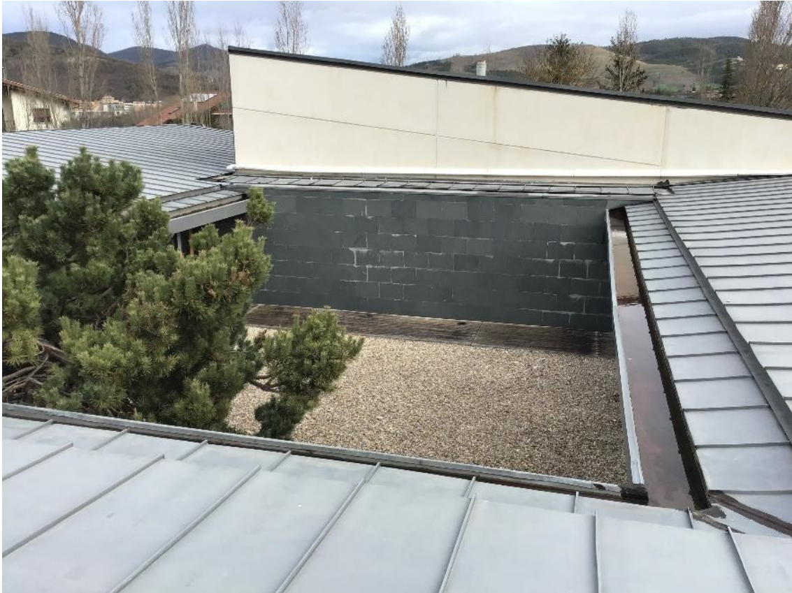
Falta de mantenimiento de canalones y bajantes
