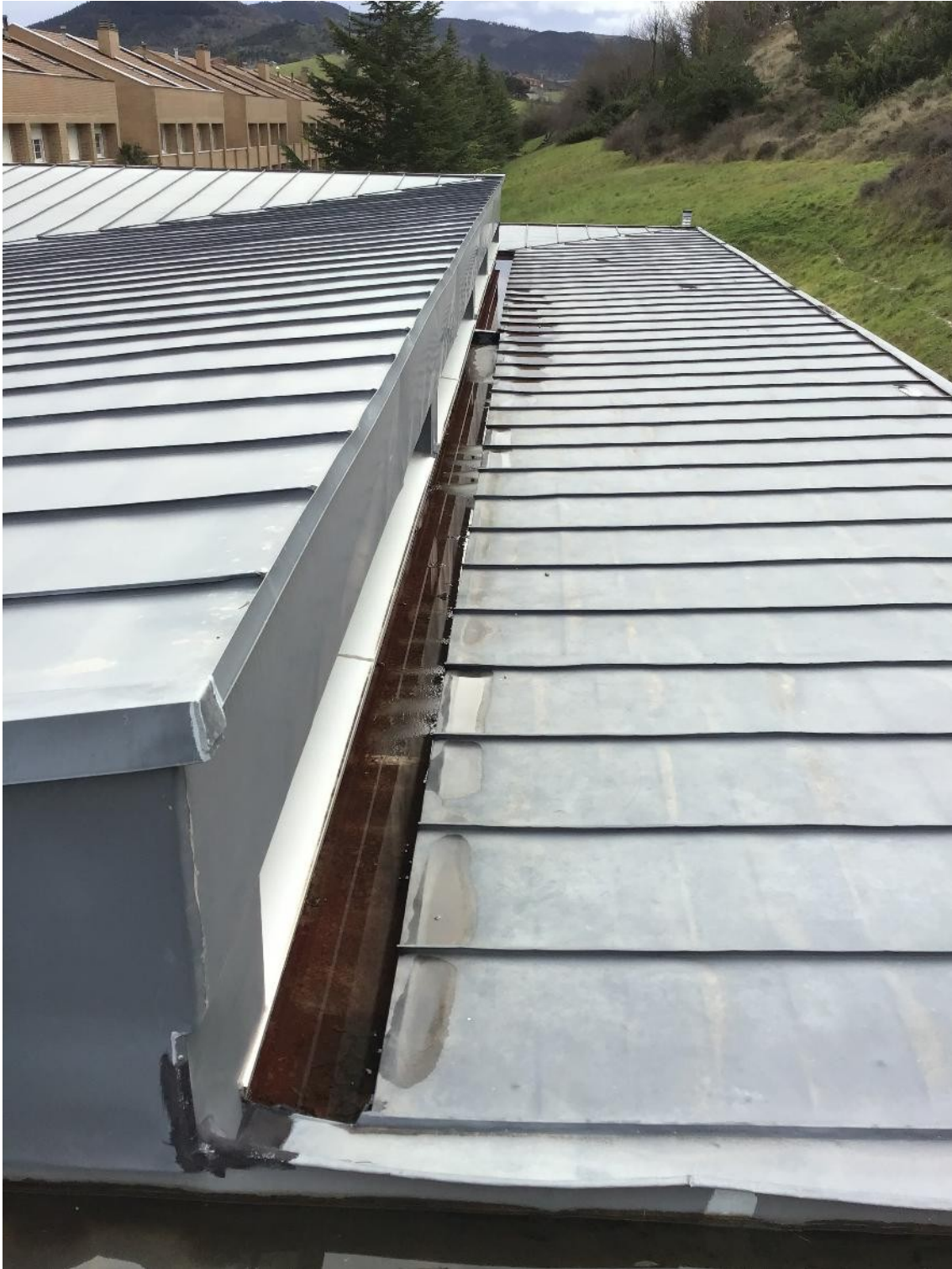
Falta de mantenimiento de canalones y bajantes. Reparaciones de urgencia.
