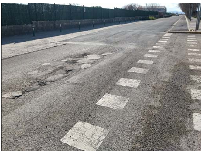
ESTADO DEL FIRME
