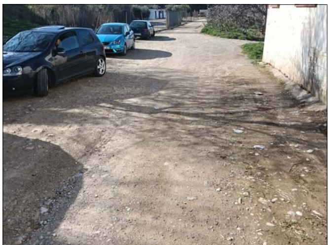
TRAMO DE CAMINO SIN ASFALTAR
