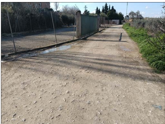
TRAMO DE CAMINO SIN ASFALTAR
