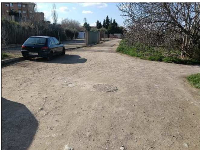
TRAMO DE CAMINO SIN ASFALTAR
