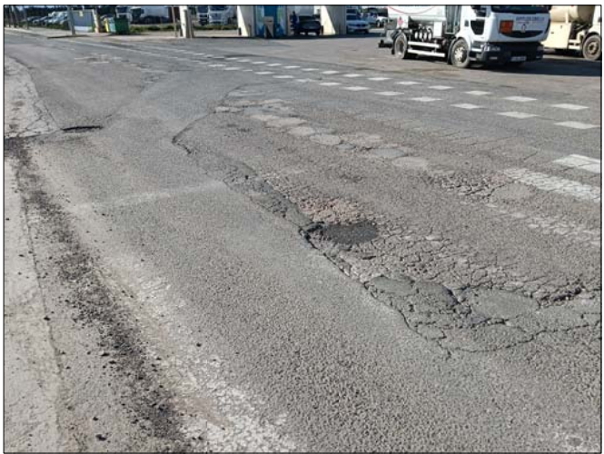
ESTADO DEL FIRME
