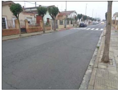
TRAMO A P.P. N° 88
