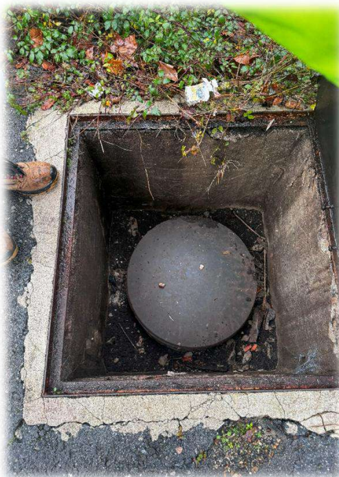
Fotografía 3 – Fosa séptica de una de las industrias.
