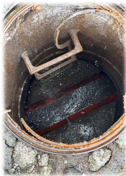
Fotografía 15 – Pozo de red de pluviales afectada por el proyecto.
