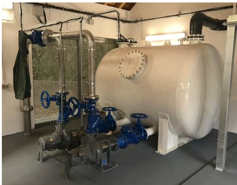
Estación de vacío
