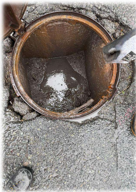
Fotografía 11 – Pozo de red de pluviales afectada por el proyecto.
