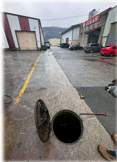
Fotografía 6 – Colector afectado por la obra.
