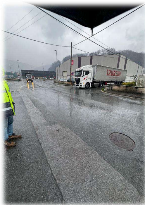
Fotografía 13 – Arqueta de conducción de agua afectada por el proyecto.
