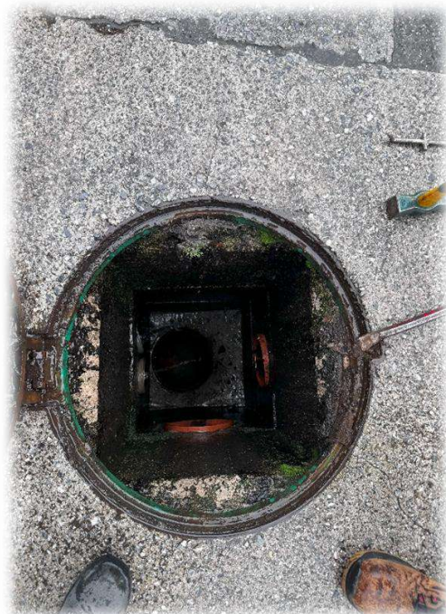
Fotografía 10 – Arqueta de red de pluviales afectada por el proyecto.
